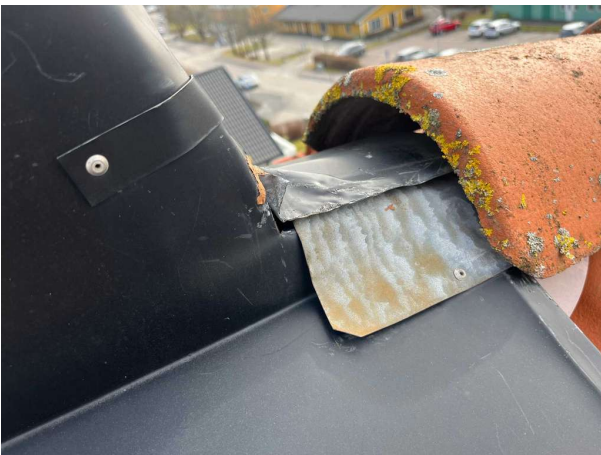
Bild 3: - Utvändigt, Tak, Underbeslag saknas på murstocken och brister noteras plåthuv runt murstocken. Se Riskanalys.
