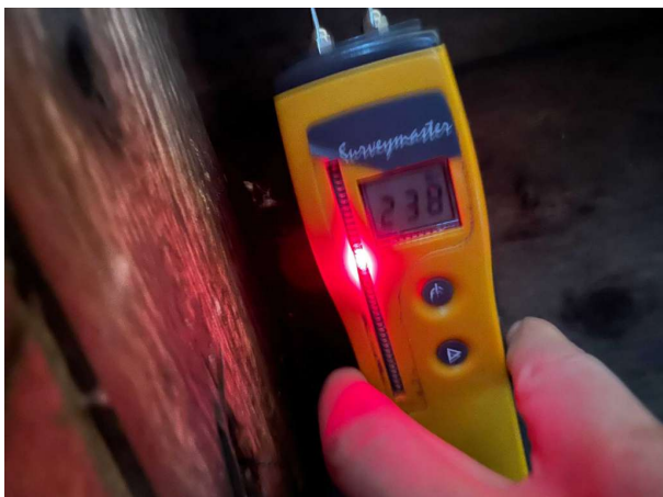
Bild 6: Utvändigt, Vind, Fuktfläckar noteras på insida yttertak. Vid stickprovskontroll med fuktindikator noteras förhöjda...
