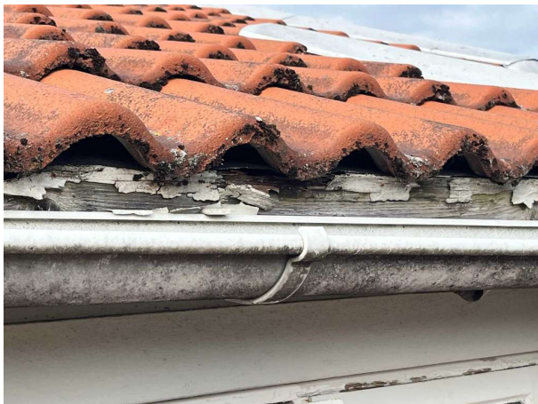
Bild 4: Utvändigt, Tak, Omfattande färgsläpp och rötskador noteras på fotbräda.
