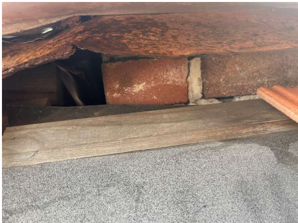
Bild 2: - Utvändigt, Tak, Underbeslag saknas på murstocken och brister noteras plåthuv runt murstocken. Se Riskanalys.
