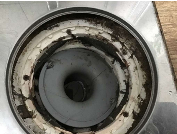
Bild 21: - Invändigt, Entréplan, Brunnsduk sticker ut under klämring. Se Riskanalys.
