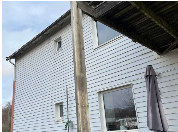
Bild 10: Utvändigt, Balkong, Balkongens bärande konstruktioner bedöms inte vara fackmässigt utförda..
