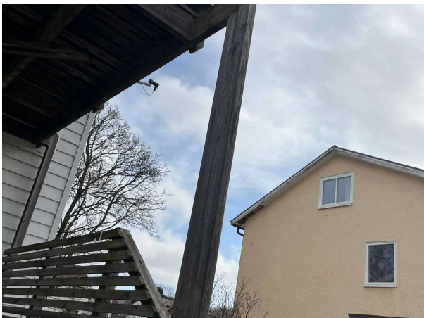
Bild 11: Utvändigt, Balkong, Balkongens bärande konstruktioner bedöms inte vara fackmässigt utförda..
