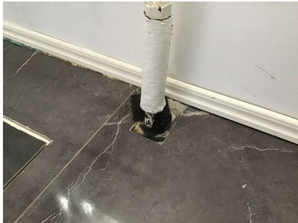
Bild 16: - Invändigt, Källare, Inkommande vattenledningar finns i utrymmet och tätskikt saknas på golv.
