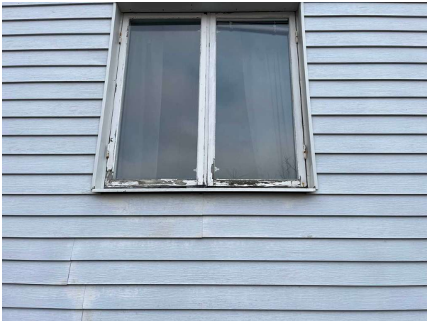
Bild 9: Utvändigt, Fönster/Dörrar, Fönster/dörrar har generellt ett eftersatt underhåll och är i behov av underhåll/renovering/byte..
