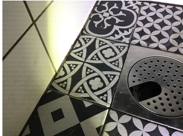
Bild 20: - Invändigt, Källare, Golvbrunn placerad för nära vägg. (Mindre än 200 mm) Se Riskanalys.
