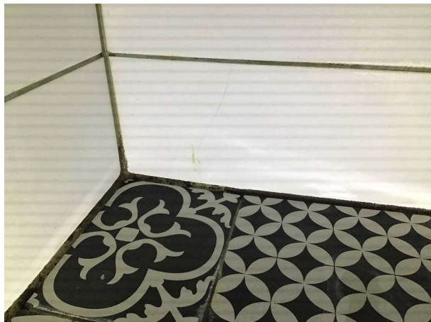
Bild 18: - Invändigt, Källare, Spricka noteras på kakel i duschzon. Se Riskanalys.
