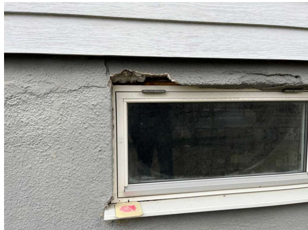
Bild 4: Utvändigt, Grundläggning, Puts och bruksläpp noteras vid källarfönster.
