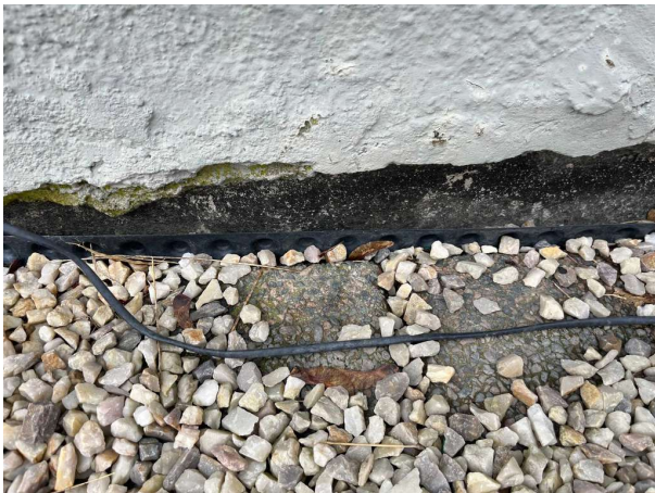
Bild 3: Utvändigt, Grundläggning, Sprickbildning och putsläpp noteras på grundmurar utvändigt på flera ställen.
