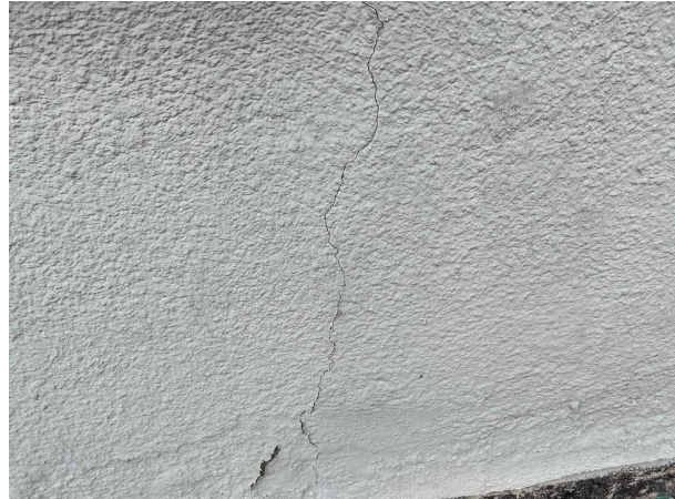
Bild 2: Utvändigt, Grundläggning, Sprickbildning och putsläpp noteras på grundmurar utvändigt på flera ställen.
