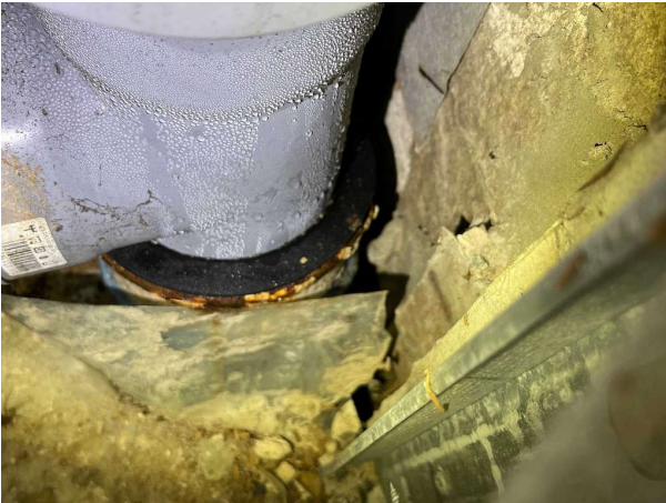
Bild 19: - Invändigt, Källare, Rostangrepp noteras på avlopps stam i installationsschakt. Se Riskanalys.
