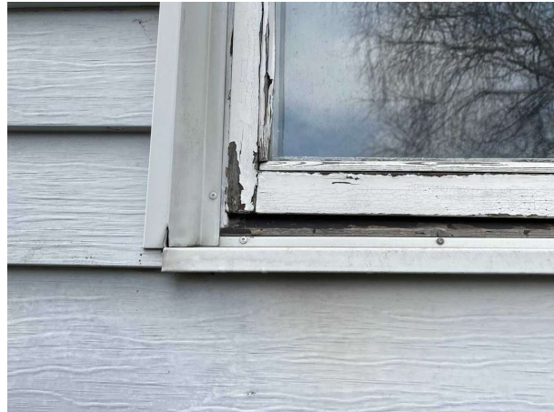
Bild 8: Utvändigt, Fönster/Dörrar, Fönster/dörrar har generellt ett eftersatt underhåll och är i behov av underhåll/renovering/byte..
