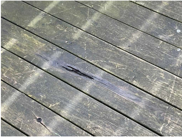
Bild 13: Utvändigt, Balkong, Balkongen bedöms vara i behov av underhåll då lokala rötskador noteras i trallen.
