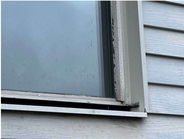
Bild 7: Utvändigt, Fönster/Dörrar, Fönster/dörrar har generellt ett eftersatt underhåll och är i behov av underhåll/renovering/byte.
