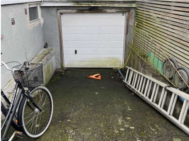
Bild 1: - Utvändigt, Mark, Det förekommer marklutningar mot grunden i form av en garagedeart.
