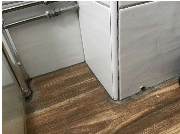
Bild 22: - Invändigt, Entréplan, Kakel på inbyggnadsdel för WC har börjat släppa i nederkant. Se Riskanalys.
