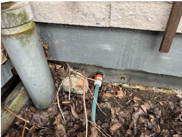
Bild 3: -Grundläggning, Vattenutkastare noteras som ej bedöms vara frostsäker. Se Riskanalys.
