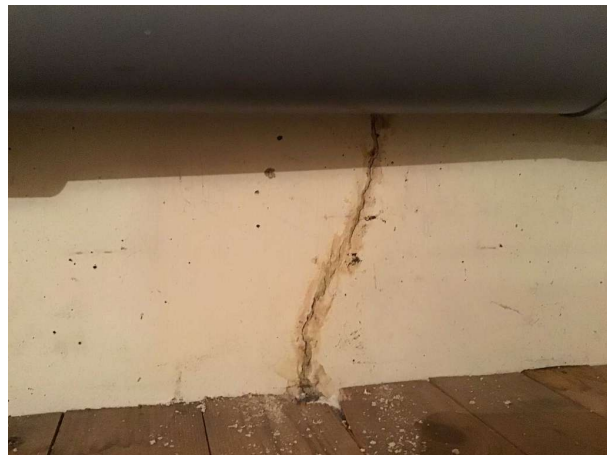
Bild 16: -Källarplan, Sprickbildning noteras på grundmur och i väggskarv vilket kan vara tecken på sättningar. Se Grundläggning.
