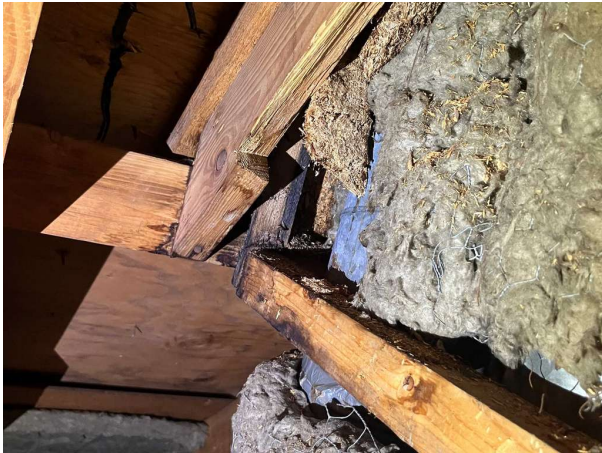
Bild 13: Vind, I anslutning till genomföring för ventilationskanaler noteras tecken på att det har förekommit problem med inträngande vatten i form av fuktrosor s...
