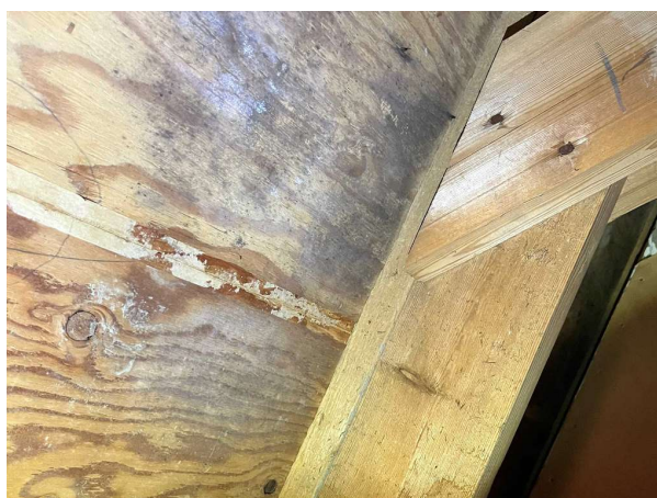
Bild 12: -Vind, Påväxt/missfärgningar på yttertakets insida noterades, vilket bör ses över för att minska risken för ytterligare skador. Se Riskanalys.
