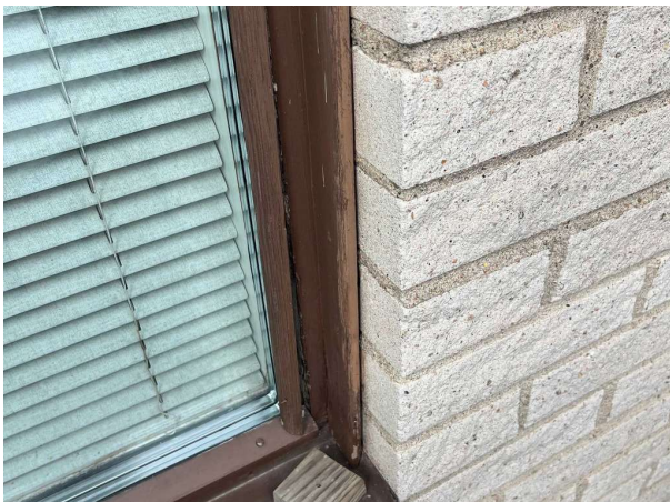
Bild 5: -Fönster/Dörrar, Fönster och dörrar med tillhörande foder är i behov av underhåll/renovering. Se Riskanalys.
