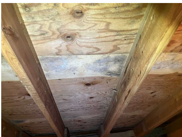
Bild 11: -Vind, Påväxt/missfärgningar på yttertakets insida noterades, vilket bör ses över för att minska risken för ytterligare skador. Se Riskanalys.
