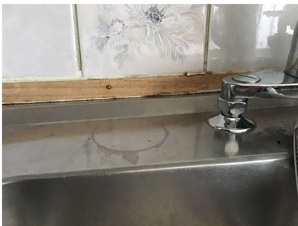
Bild 20: Entréplan, Tätning mellan bänk och vägg är bristfällig.
