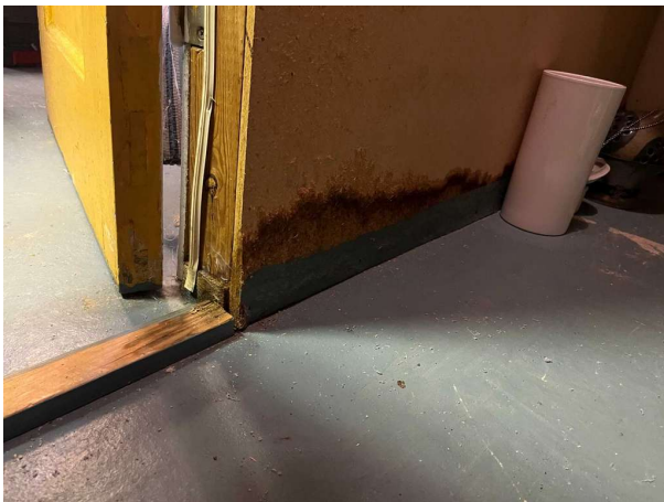
Bild 15: Källarplan, Det förekommer tecken på fuktskada på mellanvägg efter tidigare noterad fuktskada. För att kontrollera om skador uppstått i bakomliggande konstrukt...
