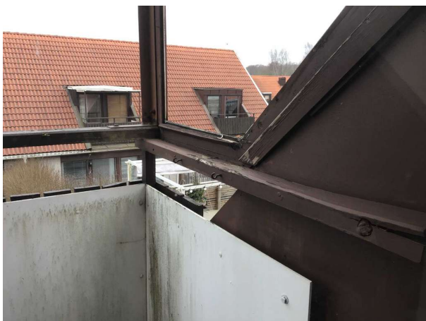
Bild 9: Balkong, Balkongen har underhållsbehov.
