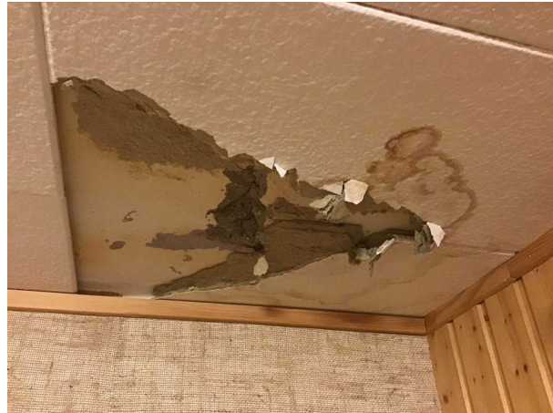
Bild 14: Källarplan, Fuktskada noteras på innertak. Se säljarens information. För att kontrollera om det uppstått skador i bakomliggande konstruktioner erfordras konstru...
