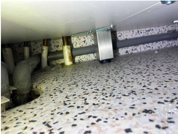
Bild 7: - Invändigt, Entréplan, Rör genomföringar noteras i golvet. Se Riskanalys.
