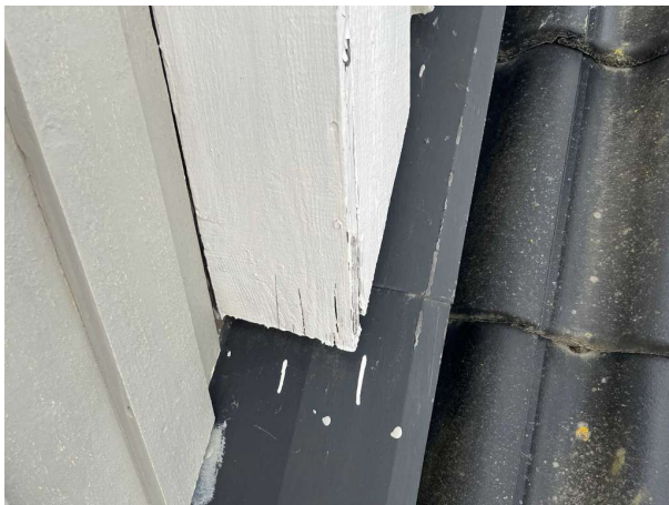
Bild 4: - Utvändigt, Fönster/Dörrar, Otäta fönster/dörromfattningar noteras i byggnaden. Se Riskanalys.
