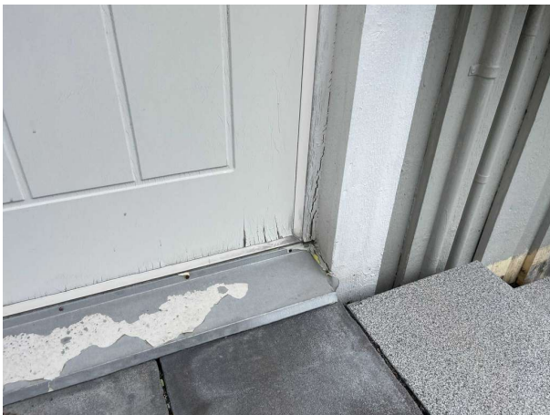
Bild 3: Utvändigt, Fönster/Dörrar, Fönster och dörrar bedöms har normalt underhållsbehov. Lokala färgsläpp noteras på karmar och fön...
