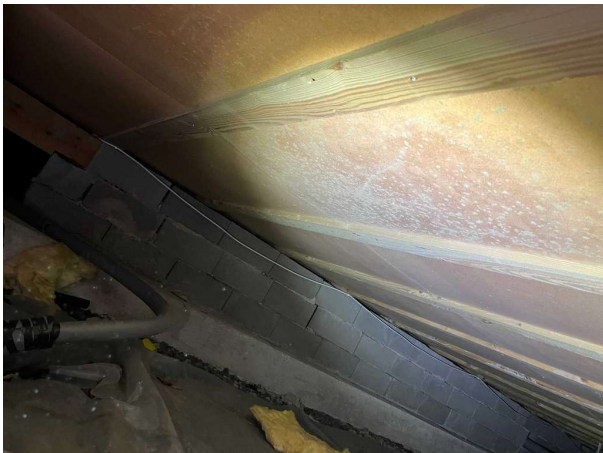
Bild 1: Utvändigt, Grundläggning, Påväxt noteras lokalt på trossbotten. Området bör rengöras och hållas under uppsikt för att i tid...
