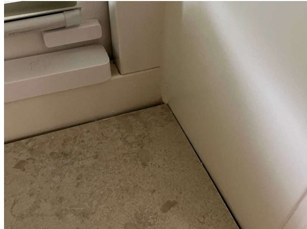
Bild 8: Invändigt, Entréplan, Bristfällig tätning mellan kakel och fönster noteras.
