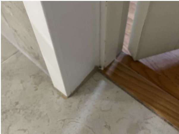
Bild 9: Invändigt, Entréplan, Våtrummetts tröskel är ej i liv med tätskiktet på väggen, vilket ej följer gällande branschregler...
