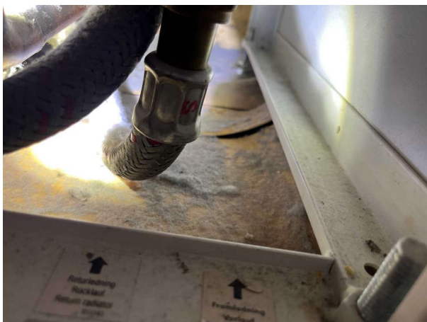
Bild 6: Invändigt, Entréplan, Plastmattan under värmepumpen bedöms ej vara utbytt i samband med renoveringen vilket är ett utfö...
