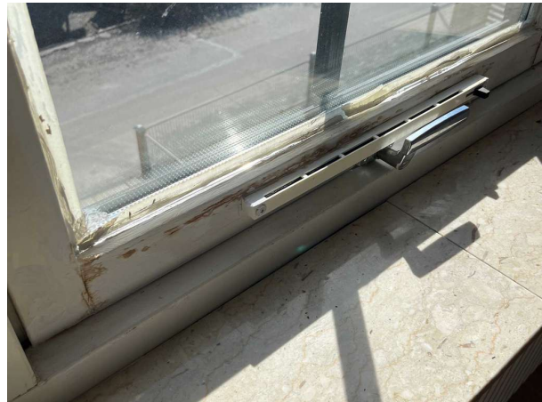
Bild 28: - Invändigt, Plan 1, Fuktrosor/missfärgningar noteras på fönster. Se notering Vardagsrum. Det noteras även rötskador p...
