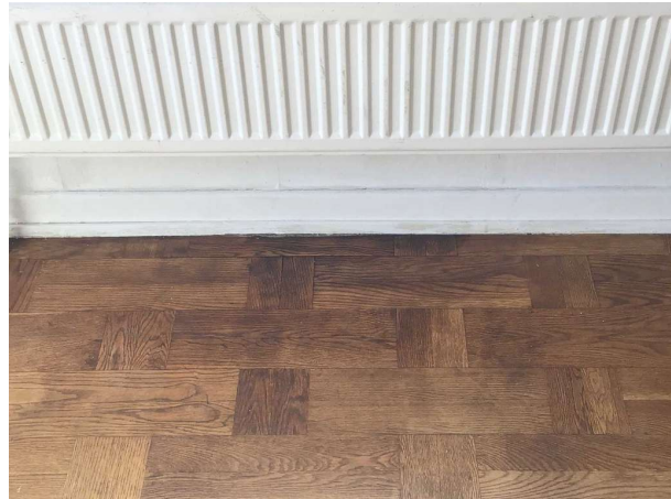
Bild 20: Invändigt, Entréplan, Fuktfläck/resning i parketten noteras under det mest skadade fönstret.
