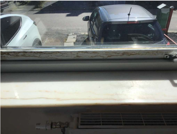
Bild 19: Invändigt, Entréplan, Missfärgning/fuktrosor noteras på ett av rummets fönster. Orsaken till förhållandet är okänd. För...
