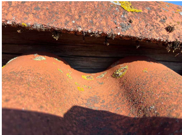
Bild 6: Utvändigt, Tak, Så kallat nockband och fotplåt saknas. Dessa kan monteras för att minska slitaget på underlagspap...
