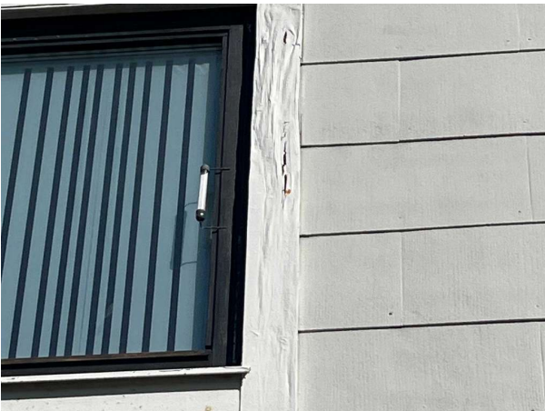
Bild 5: - Utvändigt, Fönster/Dörrar, Rötskador noteras på flera foder runt fönster. Se Riskanalys.
