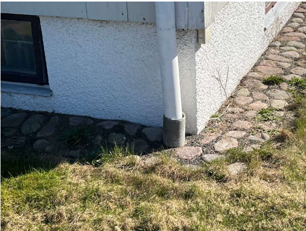
Bild 3: Utvändigt, Dagvatten/Dränering, Stuprör saknar lövsilar.
