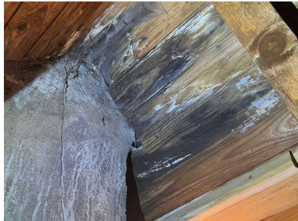
Bild 10: - Utvändigt, Vind, Tecken på läckage noteras på insida yttertak och golv. Fläckarna uppvisar vid stickprovskontroll ...
