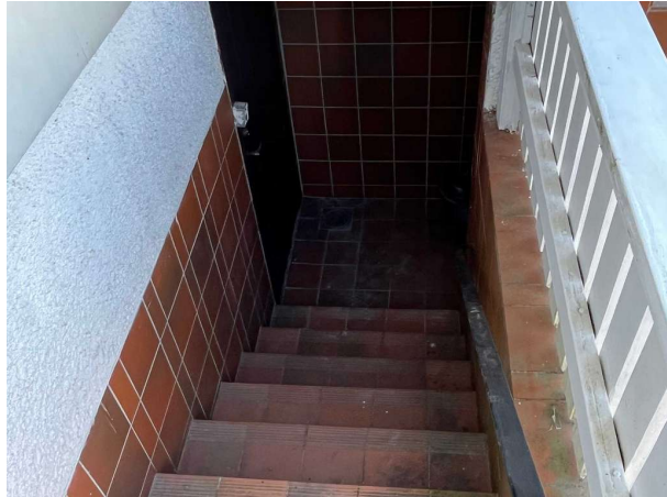
Bild 2: Utvändigt, Dagvatten/Dränering, Dagvattenbrunn noteras i nedgång till källare. Det är viktigt att dessa brunnar regelbundet rensa...
