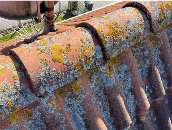
Bild 7: Utvändigt, Tak, Påväxt av mossor och lavar noteras på taket. Detta förhållande kan påverka takets tekniska livslän...
