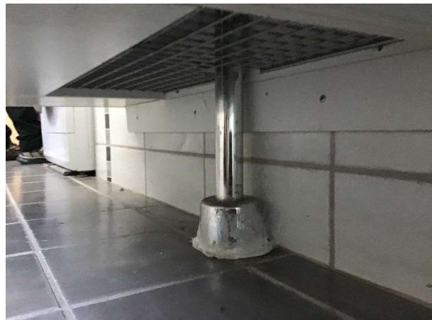
Bild 24: - Invändigt, Entréplan, Våtrummet bedöms inte vara fackmässigt utfört då flera felaktigheter noteras. Se Riskanalys.
