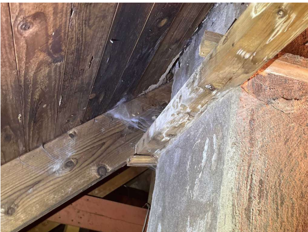
Bild 11: - Utvändigt, Vind, Tecken på läckage noteras på insida yttertak och golv. Fläckarna uppvisar vid stickprovskontroll ...
