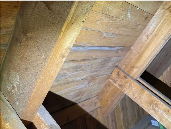
Bild 25: - Invändigt, Plan 1, Missfärgning/påväxt noteras på insida yttertak. Se Riskanslys.
