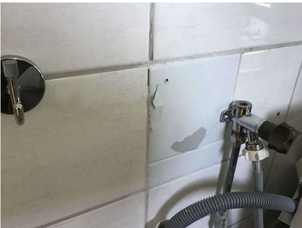
Bild 23: - Invändigt, Entréplan, Våtrummet bedöms inte vara fackmässigt utfört då flera felaktigheter noteras. Se Riskanalys.
