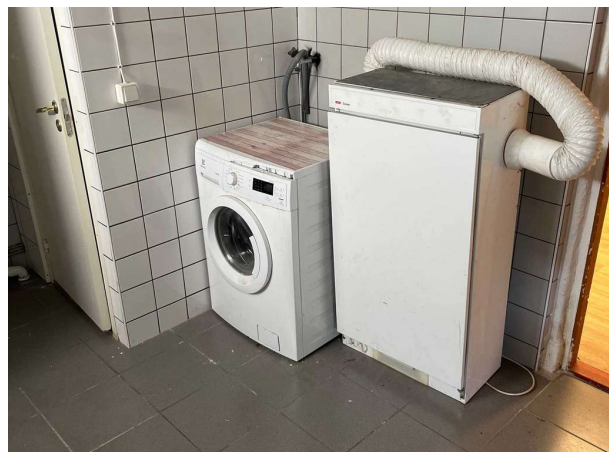
Bild 18: - Invändigt, Källarplan, Utrymmet bedöms ej vara fackmässigt utfört då det bland annat saknas golvbrunn. Se Riskanalys.
