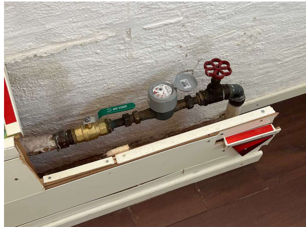
Bild 16: - Invändigt, Källarplan, Installationsutrymme för inkommande vatten finns i rummet och saknar tätskikt samt dränage. Se Ri...
