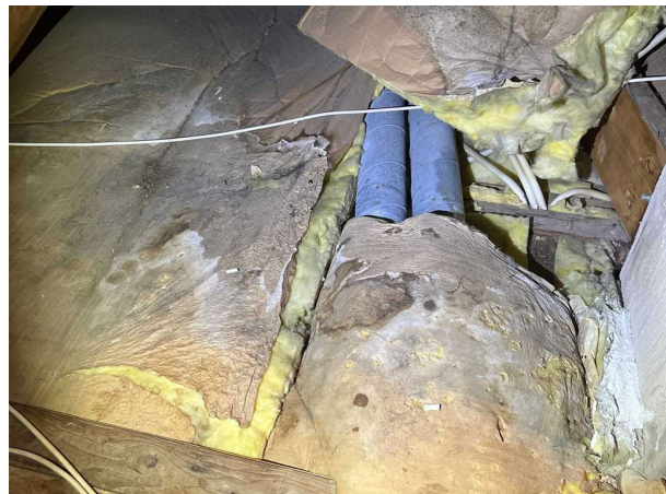
Bild 12: - Utvändigt, Vind, Tecken på läckage noteras på insida yttertak och golv. Fläckarna uppvisar vid stickprovskontroll ...
