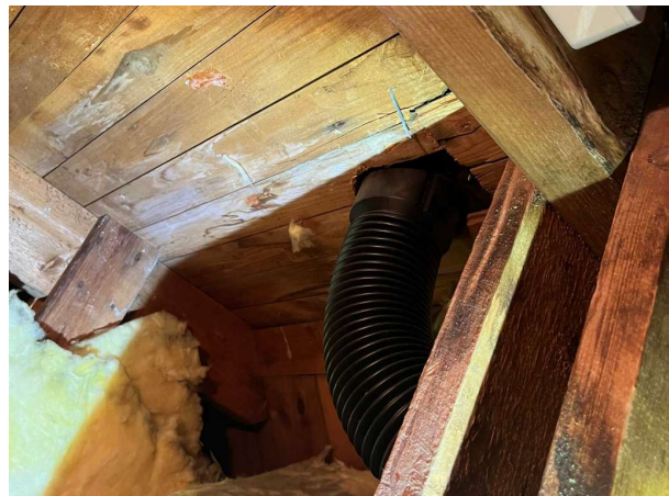
Bild 30: Invändigt, Plan 1, Missfärgningar/fuktrosor noteras på insida yttertak i anslutning till avloppsluftare. Området var...
