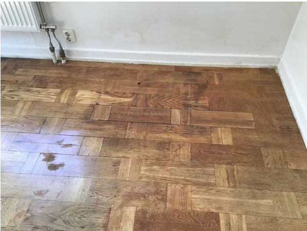
Bild 21: - Invändigt, Entréplan, Tecken på fuktskada noteras på golvet. Orsak okänd. Se Fortsatt teknisk utredning.
