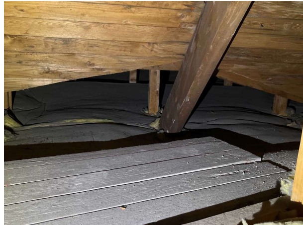
Bild 14: Utvändigt, Vind, Delar av vinden är inte åtkomlig för kontroll på grund av att det saknas gångbroar.
