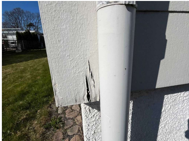
Bild 4: - Utvändigt, Fasad, Rötskador noteras på hörnbrädor. Se Riskanalys.
