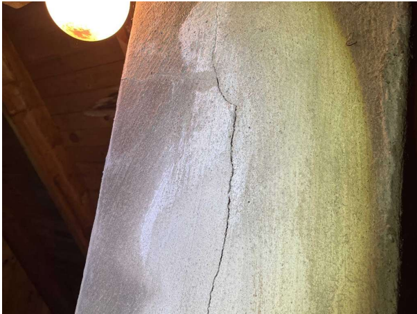
Bild 13: - Utvändigt, Vind, Sprickbildning noteras på murstock. Rekommenderar kontakt med behörig fackman för lämpliga åtgärder.
