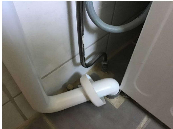
Bild 22: - Invändigt, Entréplan, Våtrummet bedöms inte vara fackmässigt utfört då flera felaktigheter noteras. Se Riskanalys.
