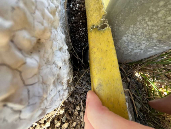
Bild 1: Utvändigt, Dagvatten/Dränering, Fuktisoleringen bedöms ej vara fackmässigt utförd då den på framsidan avslutas innan hörnet på by...
