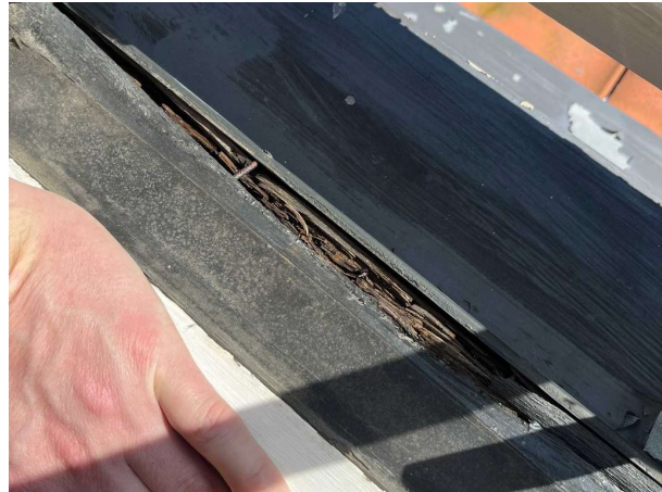
Bild 26: - Invändigt, Plan 1, Fuktrosor/missfärgningar noteras på fönster. Se notering Vardagsrum. Det noteras även rötskador p...
