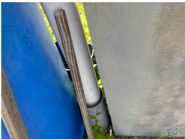
Bild 9: Utvändigt, Dränering/Dagvatten, Det förekommer stuprör som saknar lövsilar.
