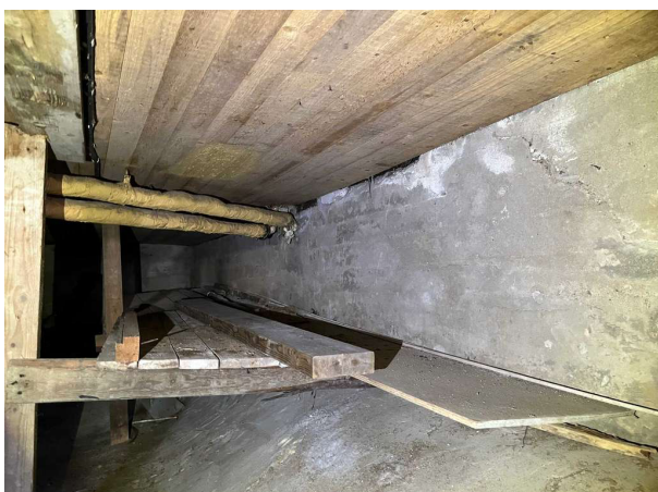
Bild 5: Utvändigt, Grundläggning, Organiskt material som vid uppfuktning kan avge en dålig lukt noteras i krypgrunden. Rekommendera...
