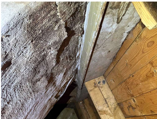
Bild 14: Utvändigt, Vind, I anslutning till murstocken noteras lokalt på insida yttertak bland annat i anslutning till murs...
