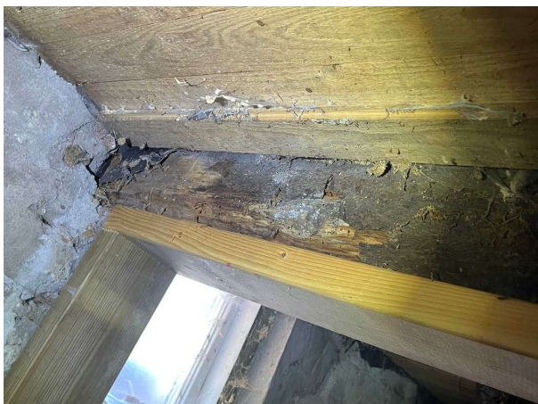
Bild 3: - Utvändigt, Grundläggning, I krypgrunden noteras rötskador på en bärande bjälke. Se Fortsatt teknisk utredning.
