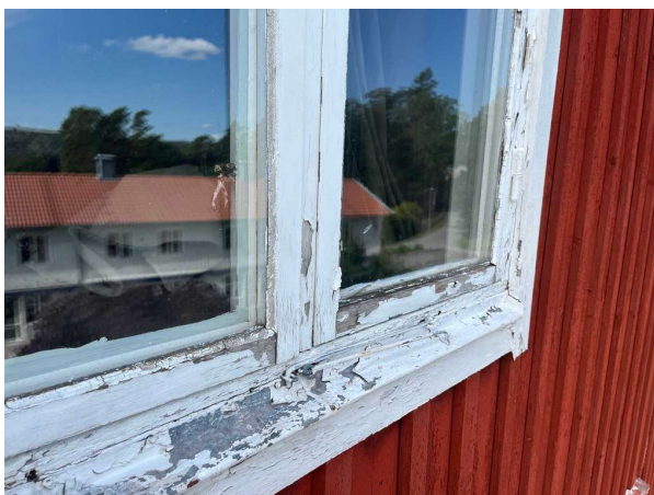
Bild 12: Utvändigt, Fönster/Dörrar, Äldre fönster har ett eftersatt underhåll då bland annat omfattande färgsläpp noteras.
