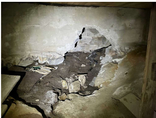
Bild 4: - Utvändigt, Grundläggning, I krypgrunden noteras tecken på att det kan tränga in vatten via marken in i grunden. Se Riskana...
