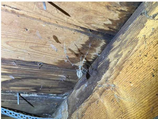
Bild 13: Utvändigt, Vind, I anslutning till murstocken noteras lokalt på insida yttertak bland annat i anslutning till murs...
