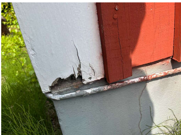
Bild 11: - Utvändigt, Fasad, Fasaden har underhållsbehov då sprickbildning och lokala rötskador noteras i fasaden. Se Riskana...
