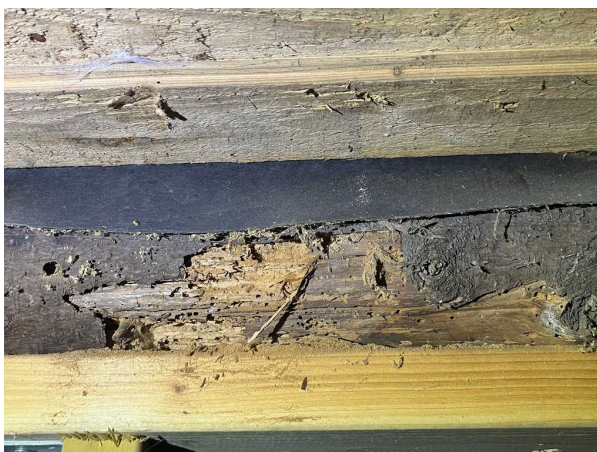
Bild 2: - Utvändigt, Grundläggning, I krypgrunden noteras rötskador på en bärande bjälke. Se Fortsatt teknisk utredning.
