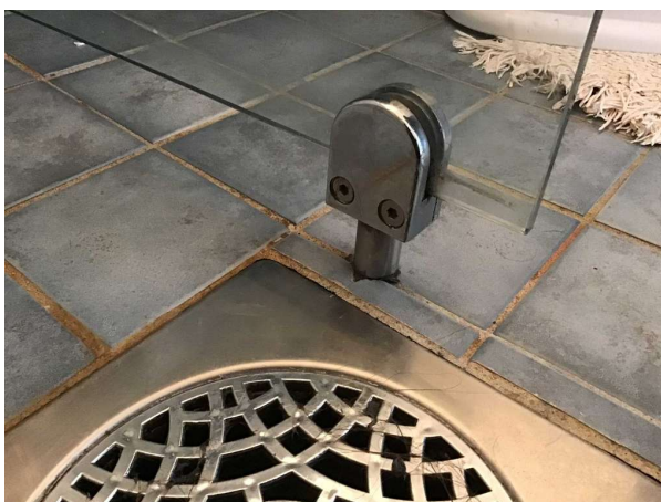
Bild 6: - Invändigt, Entréplan, Det förekommer håltagning i tätskikt på golv intill golvbrunn för infästning av duschvägg. Se Ris...
