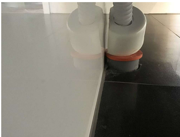
Bild 6: Invändigt, Entréplan, Avloppsrör för handfat kommer upp genom tätskikt på golv för nära vägg. Minsta avstånd skall vara...
