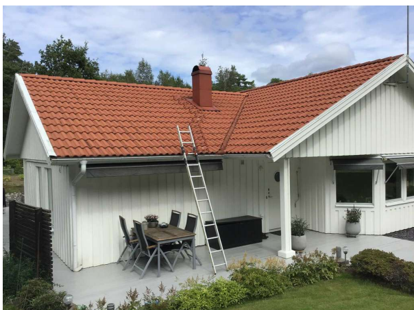
Bild 1: Utvändigt, Fasad, Trätall noterades mot fasaden vilket innebär ett ökat slitage på fasaden samt en risk för fuktrela...
