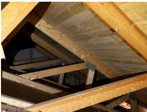
Bild 4: Utvändigt, Vind, Delar av vinden är ej åtkomlig för besiktning på grund av att det saknas landgångar.
