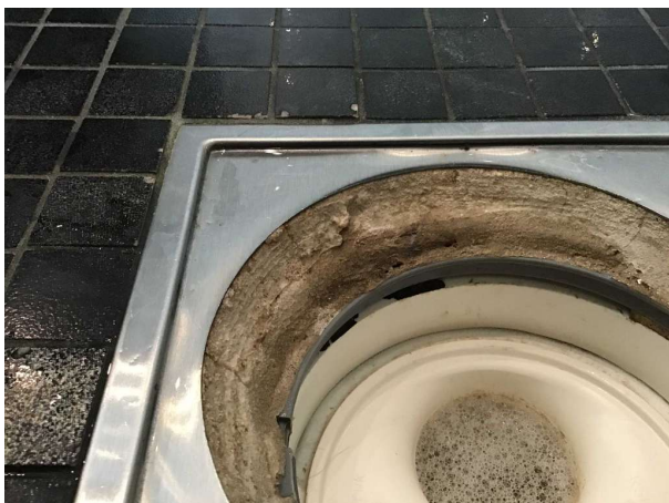
Bild 5: - Invändigt, Entréplan, Klämrings ej nedtryckt i sitt rätta läge. Se Riskanalys.
