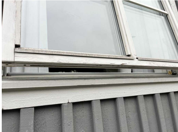
Bild 2: Utvändigt, Fönster/Dörrar, Fönster och dörrar har underhållsbehov. Färgsläpp noteras.
