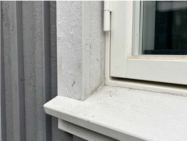
Bild 5: Utvändigt, Fönster/Dörrar, Otäta fönster/dörromfattningar noteras i byggnaden. Samtliga fönster saknar bleck av plåt och gli...
