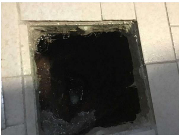
Bild 9: - Invändigt, Allmänt, Det förekommer äldre gjutjärnsbrunnar och rör i byggnaden. Se Riskanalys.
