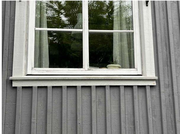
Bild 6: - Utvändigt, Fönster/Dörrar, Fönster i köket uppvisar rötskador. Se Riskanalys.
