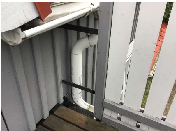
Bild 7: Utvändigt, Balkong, Råcket bedöms ej vara barnsäkert. Risk för personskada föreligger.
