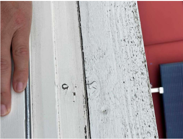
Bild 3: Utvändigt, Fönster/Dörrar, Otäta fönster/dörromfattningar noteras i byggnaden. Samtliga fönster saknar bleck av plåt och gli...
