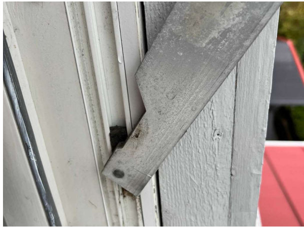
Bild 4: Utvändigt, Fönster/Dörrar, Otäta fönster/dörromfattningar noteras i byggnaden. Samtliga fönster saknar bleck av plåt och gli...
