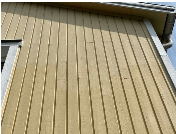
Bild 4: Utvändigt, Fasad, Fasadpanelen är skarvad vilket innebär en ökad risk för skador på panelen och bakomliggande konst...
