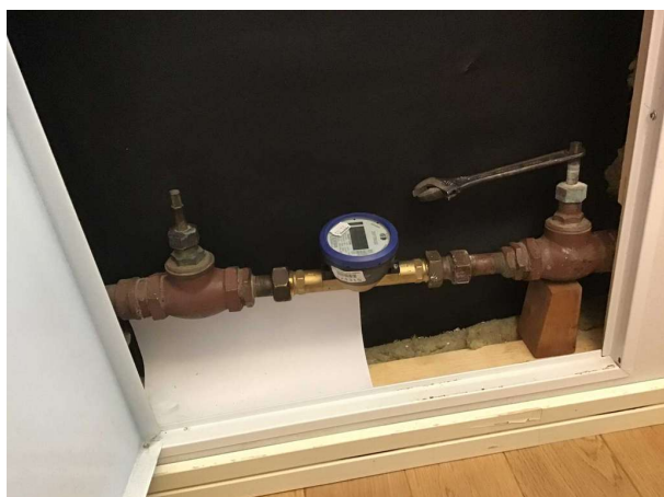
Bild 5: - Invändigt, Sutterängplan, Installationsutrymme för inkommande vattenledningar saknas tätskikt och dränage. Se Riskanalys.
