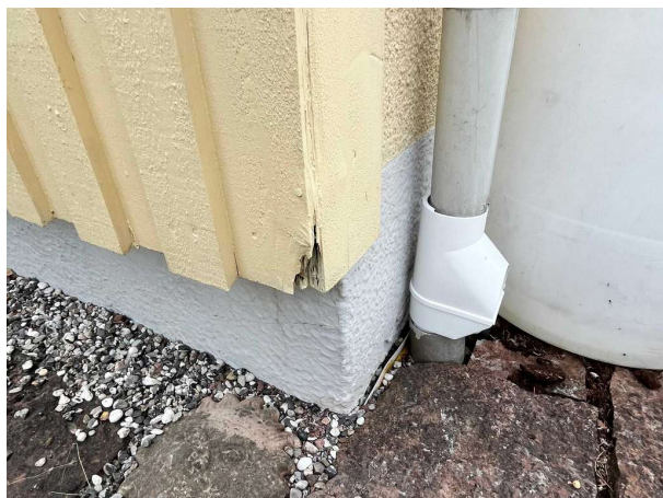
Bild 3: - Utvändigt, Fasad, Rötskadad fasadpanel noteras lokalt på gavlar och uterum. Se Riskanalys.
