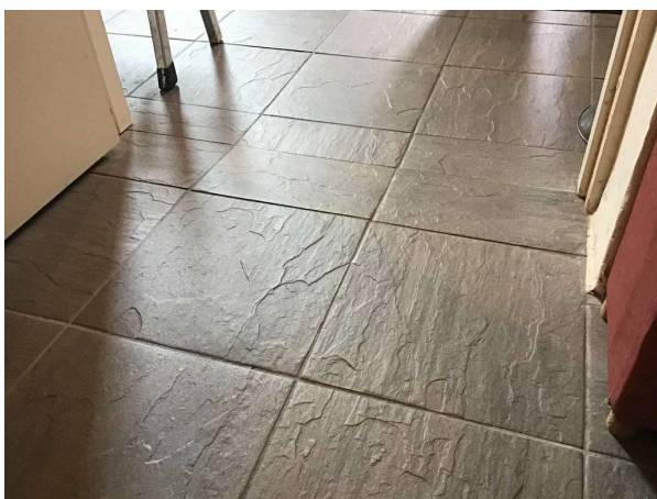
Bild 6: - Invändigt, Sutterängplan, Utrymmet saknar tätskikt på golvet med uppvik på väggar och trösklar saknas. Se Riskanalys.
