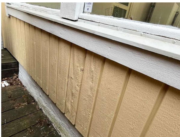
Bild 2: - Utvändigt, Fasad, Rötskadad fasadpanel noteras lokalt på gavlar och uterum. Se Riskanalys.
