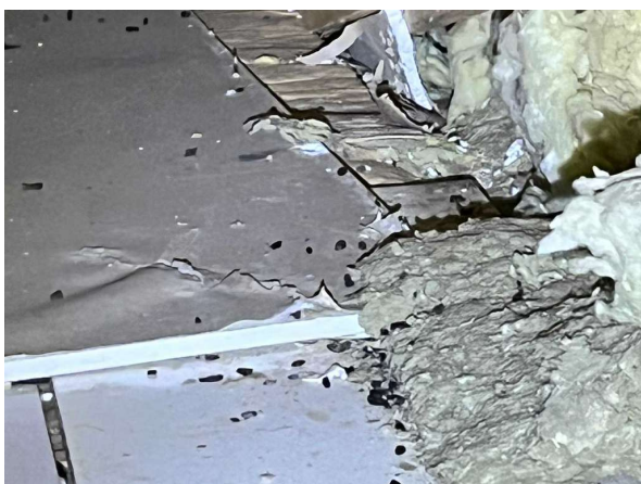
Bild 5: -Vind, Spår av skadedjur i form av spillning efter gnavare på vinden. Se Fortsatt teknisk utredning.
