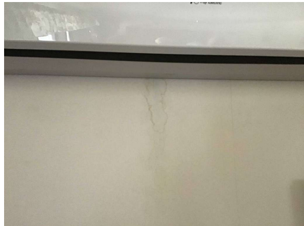
Bild 8: Entréplan, Det noteras fuktros på väggen under värmepumpen. Fläcken var torr vid besiktningen. Skadan bedöms som kosmetiskt.
