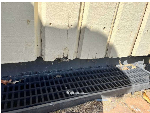
Bild 3: Fasad, Fasaden bedöms generellt ha normalt underhållsbehov. Lokala rötskador noteras varför den skadade panelen bör bytas. Det är viktigt att noga kontrol...
