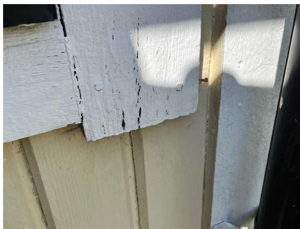
Bild 2: Fasad, Fasaden bedöms generellt ha normalt underhållsbehov. Lokala rötskador noteras varför den skadade panelen bör bytas. Det är viktigt att noga kontrol...
