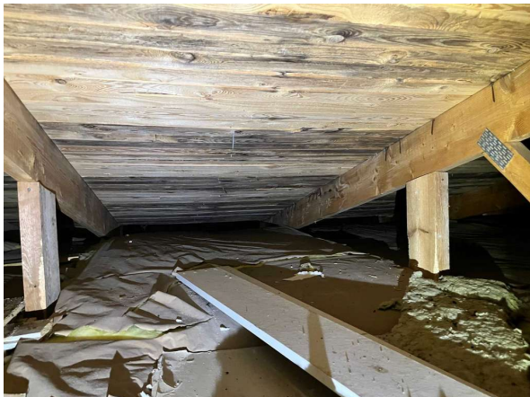
Bild 7: -Vind, Påväxt/missfärgningar på yttertakets insida noterades, vilket bör ses över för att minska risken för ytterligare skador.
