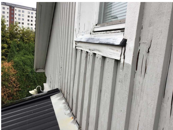
Bild 3: -Fasad, Fasaden på gavel mot vägen uppvisar kraftiga rötskador. Se Fortsatt teknisk utredning.
