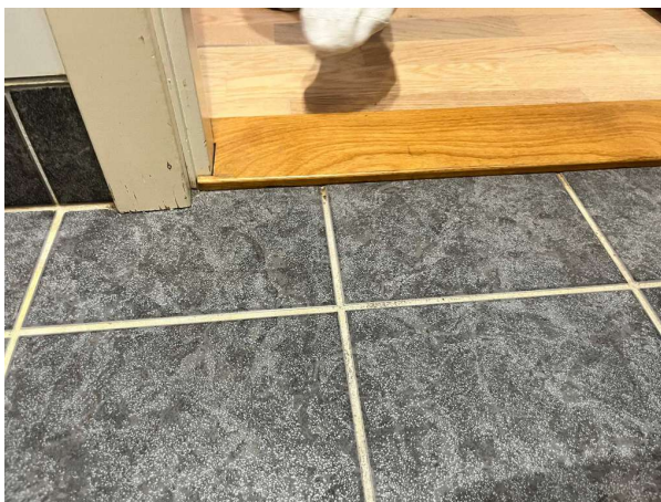
Bild 16: -Gästlägenhet, Fallet på golvet bedöms som bristfälligt och uppvikt tätskikt saknas på tröskel. Se Riskanalys.
