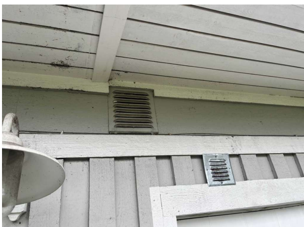
Bild 5: -Fasad, Det noteras frånluftsventiler från vad bedöms vara ett våtrum eller kök i fasaden. Ventilerna kommer från gästlägenheten. Rekommenderar kontakt med...
