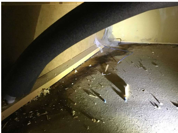
Bild 13: Plan 1, Det förekommer fuktrosor på golvet i utrymmet. Dessa var torra vid besiktningen men bör markeras och hållas under uppsikt för att i tid kunna upptä...
