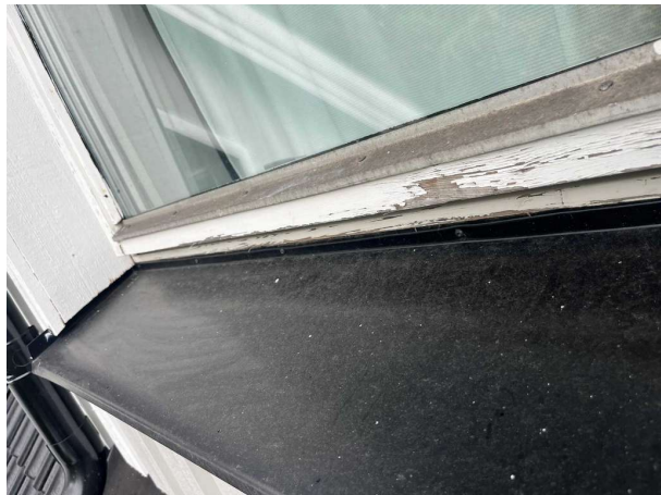
Bild 8: Fönster/Dörrar, Fönster och dörrar har underhållsbehov då bland annat färgsläpp noteras.
