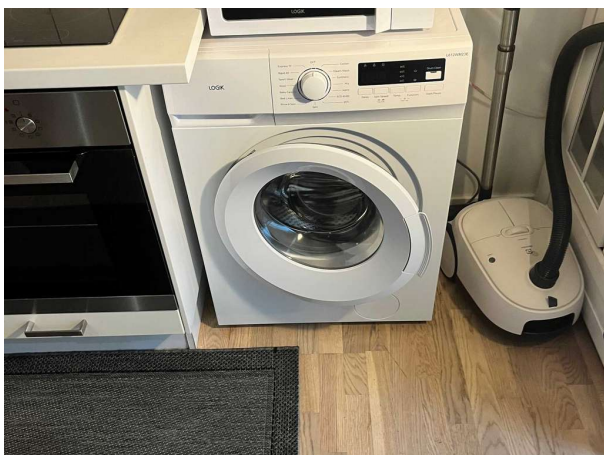
Bild 17: -Gästlägenhet, I utrymmet har man installerat en tvättmaskin. Det saknas dock både tätskikt på golvet samt golvbrunn. Se Riskanalys.
