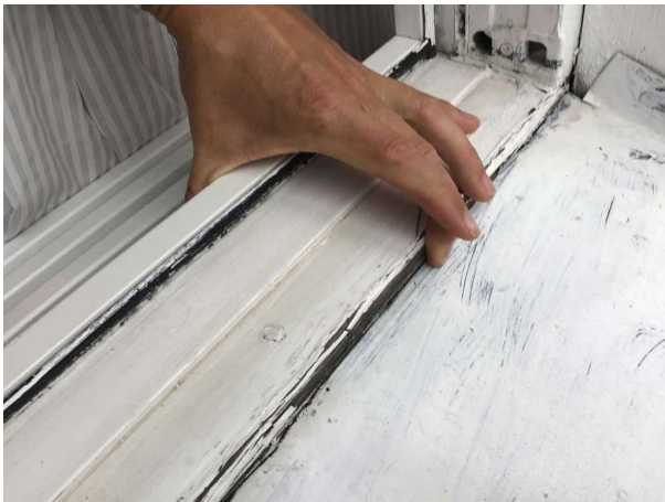
Bild 7: -Fönster/Dörrar, Felaktigt utförda fönsterbleck noteras i sovrummen på övervåningen. Se Riskanalys.
