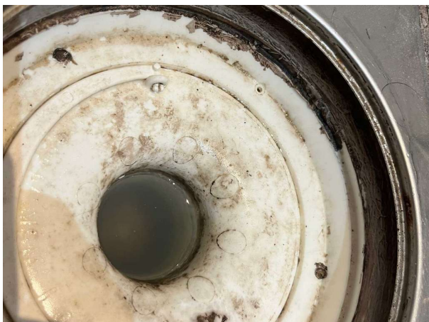
Bild 15: -Gästlägenhet, Tätskikt samt klämring noteras i golvbrunnen. Se Riskanalys.
