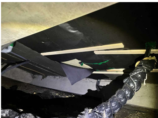
Bild 1: Grundläggning. Trossbotten har lokalt släppt från sina infästningar och behöver fästas upp igen.
