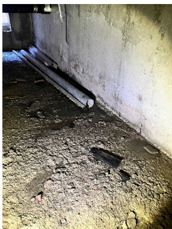
Bild 1: Utvändigt, Grundläggning, Vid inträde i grunden som sker på gaveln noteras en avvikande lukt. Det noteras även pölar med st...
