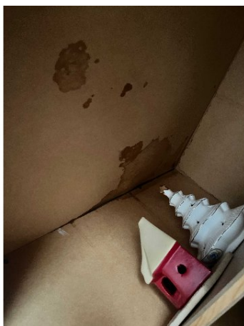
Bild 9: - Invändigt, Entréplan, Fuktrosor noteras på innertak i garderob. Fläckarna var torra vid besiktningstillfället men bör m...
