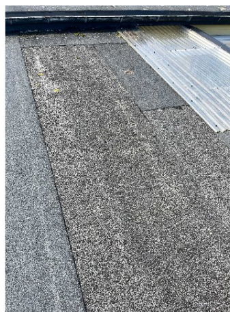
Bild 8: Utvändigt, Tak, Taket ovan förrådet bedöms vara i sämre skick och det noteras även att plast taket ovan entrén ha...
