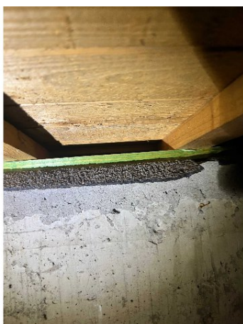
Bild 3: Utvändigt, Grundläggning, Träskyddsbehandlat virke noteras i grunden. Detta typ av material kan vid uppfuktning avge emissi...
