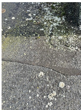
Bild 6: - Utvändigt, Tak, Ytpappen uppvisar mycket krakeleringar samt att ytbeläggningen har börjat försvinna. Se Riskanalys.
