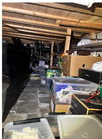
Bild 2: Utvändigt, Grundläggning, Organiskt material som vid uppfuktning kan avge en dålig lukt noteras i krypgrunden då flera av g...
