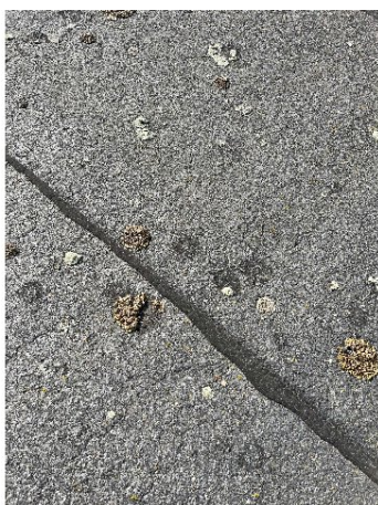
Bild 5: - Utvändigt, Tak, Ytpappen uppvisar mycket krakeleringar samt att ytbeläggningen har börjat försvinna. Se Riskanalys.
