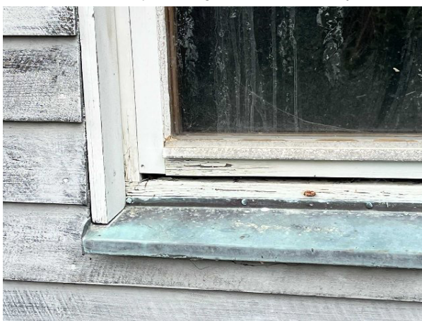
Bild 6: Fönster/Dörrar, Fönster och dörrar bedöms generellt ha ett normalt underhållsbehov. Färgsläpp noteras.
