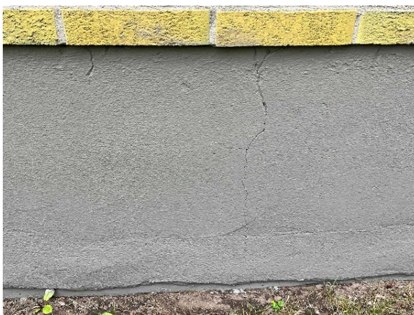
Bild 2: Grundläggning, Mindre sprickbildning noteras på grundmurar utvändigt. Sprickorna bedöms i sin nuvarande form ej påverka byggnadens goda bestånd men bör hållas und...
