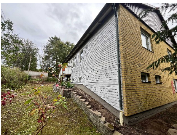
Bild 4: -Dagvatten/Dränering, Det förekommer stuprör som ej ansluter till markrör på ett fullgott sätt. Se Riskanalys.
