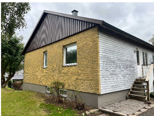
Bild 3: Fasad, Träpanelen har underhåll/målningsbehov.
