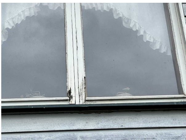
Bild 5: -Fönster/Dörrar, Rötskadat fönster noteras i köket. Se Riskanalys.
