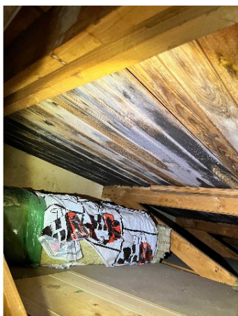
Bild 1: -Vind, Påväxt noteras på insida yttertak. Se Riskanalys.
