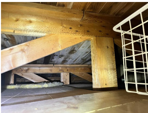
Bild 2: -Vind, Påväxt noteras på insida yttertak. Se Riskanalys.
