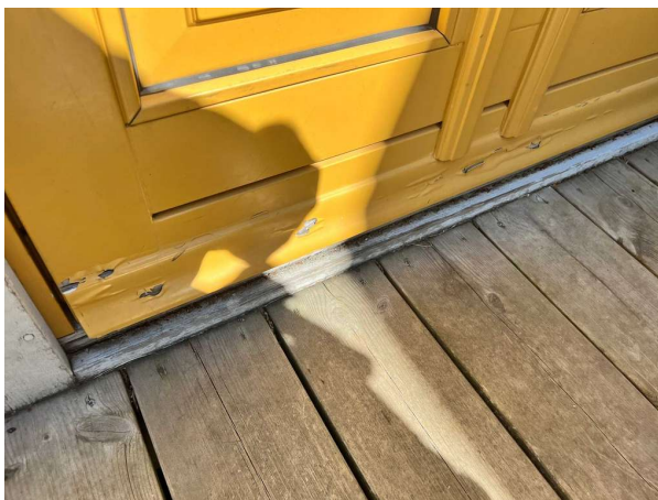
Bild 10: Utvändigt, Fönster/Dörrar, Fönster och dörrar har generellt ett underhållsbehov. Det noteras färgsläpp på några fönster samt...
