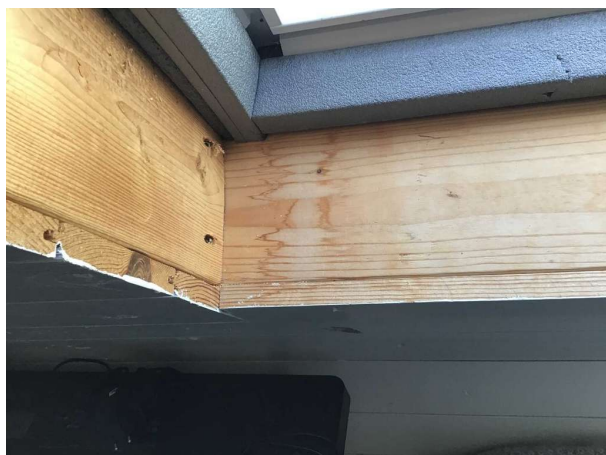
Bild 27: Invändigt, Plan 1, Rinnmärken noteras på regel under takfönster. Rosorna var torra vid besiktningen, men bör markera...
