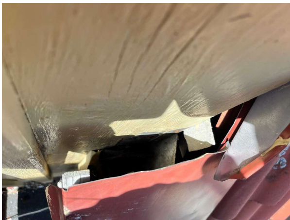
Bild 14: - Utvändigt, Tak, Felaktigt utförda anslutningsplåtar noteras mellan tak och kupan. Se Riskanalys.
