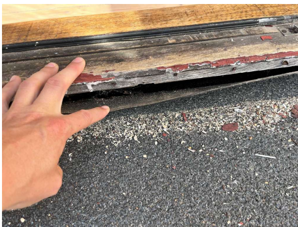
Bild 18: - Utvändigt, Balkong, Tätskiktets uppvik/anslutning mot fasad/dörr är ej korrekt utförd. Se Riskanalys.
