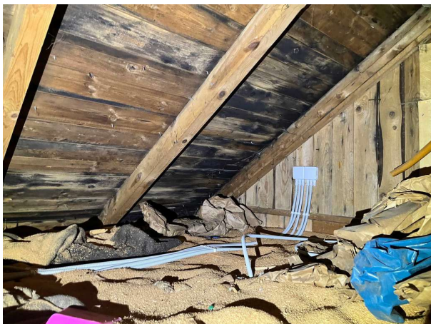
Bild 19: Utvändigt, Vind, Missfärgningar/påväxter noterades på insida yttertak. Fläckarna var ej åtkomliga för kontroll då ...
