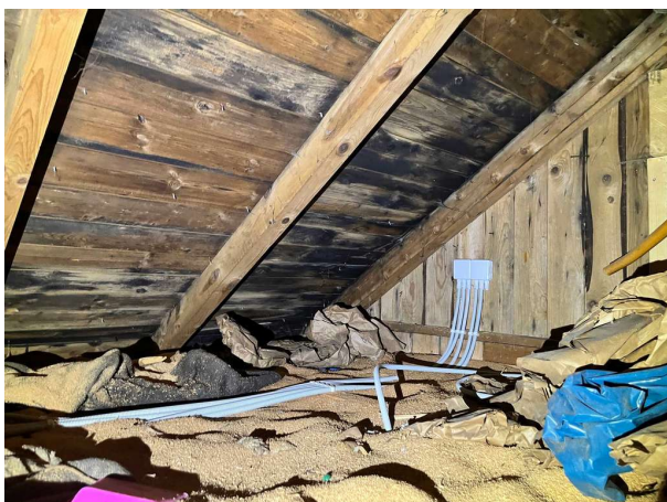
Bild 21: Utvändigt, Vind, Det noteras löst liggande material av olika typer ovan isoleringen. Detta bör tas bort.
