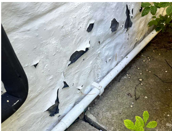
Bild 4: Utvändigt, Grundläggning, Färgsläpp noteras på grundmurar. Detta kan indikera att det förekommer fuktvandringar i grundmura...
