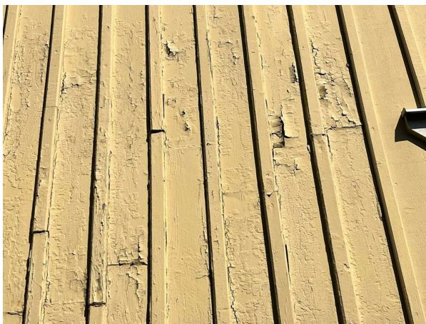
Bild 6: Utvändigt, Fasad, Fasaden har underhållsbehov. Omfattande färgsläpp och lokala rötskador noteras på framförallt gav...
