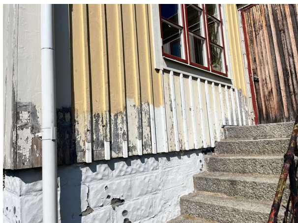
Bild 7: Utvändigt, Fasad, Fasaden har underhållsbehov. Omfattande färgsläpp och lokala rötskador noteras på framförallt gav...
