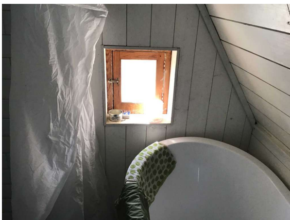
Bild 26: - Invändigt, Plan 1, Fönster noteras i våtzon 1. Se Riskanalys.
