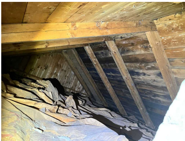
Bild 20: Utvändigt, Vind, Missfärgningar/påväxter noterades på insida yttertak. Fläckarna var ej åtkomliga för kontroll då ...
