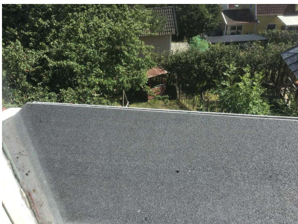
Bild 17: - Utvändigt, Balkong, Balkongen bedöms ej vara barnsäker då räcke saknas. Se Riskanalys.
