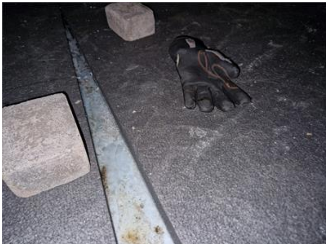
Vatten på plasten i krypgrunden.
