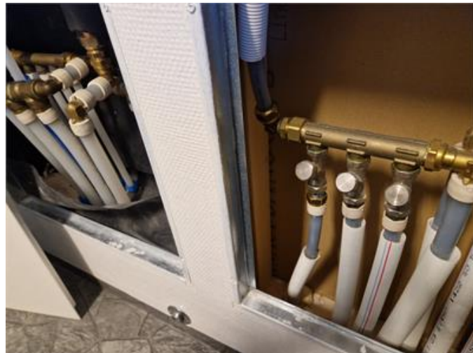
Fördelningscentraler i tvättstuga.
