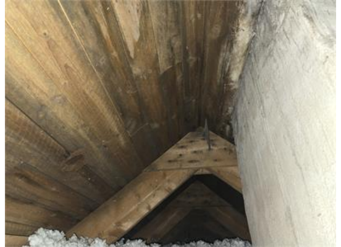
Översiktsbild vind, vy från luckan. Mikrobiell påväxt underlagstak och fläckar kring genomföringar.
