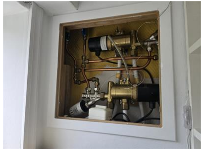
Kopplingscentral för golvvärme inbyggt i vägg, kök, källarplan.
