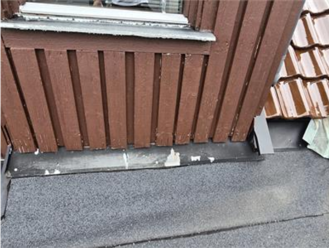
Exempelbild, rötskador träfasad.
