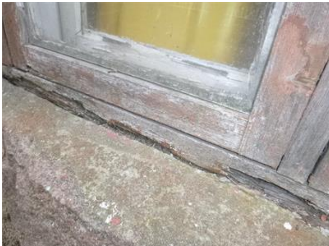
Bilden visar exempel på rötskador/skador i fönster.
