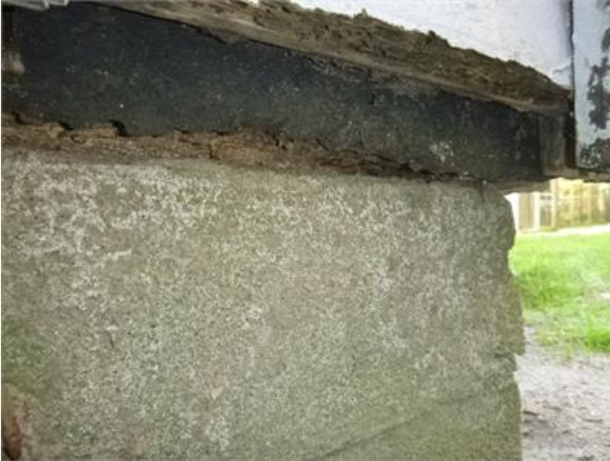
Bilden visar exempel på rötskador i fasadpanel/ytterväggssyll.
