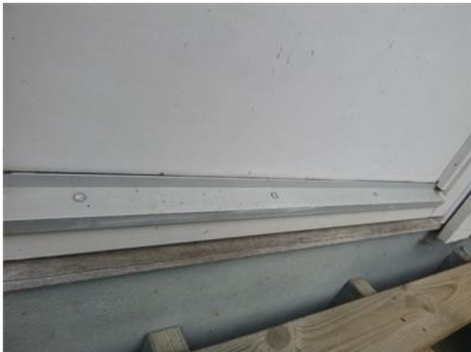
Bilden visar dörr där tröskelplåt inte finns.
