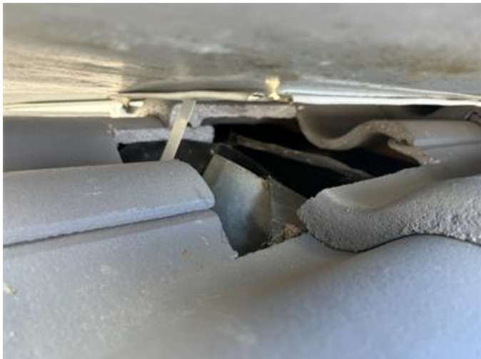
Bilden visar plåtdetalj där underbeslag saknas.
