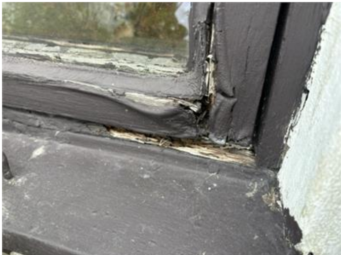
Bilden visar exempel på rötskador i fönster.
