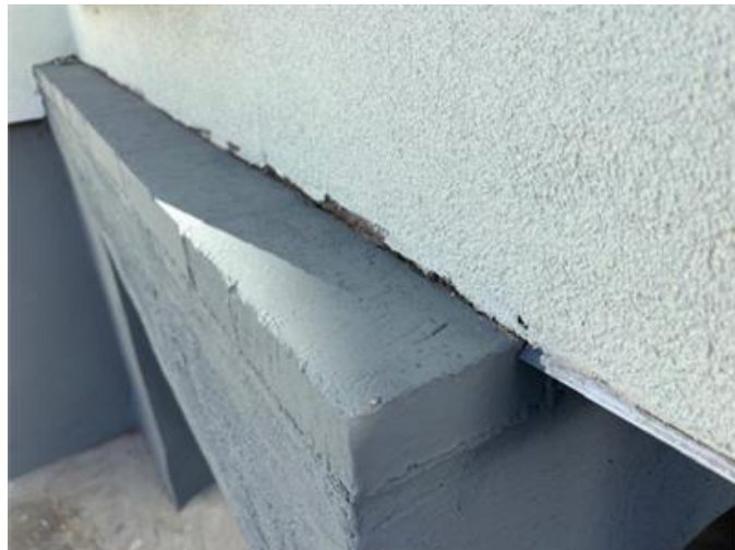
Bilden visar klack i underkant av fasad.
