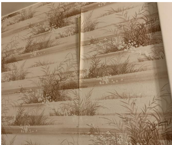
Skadat tätskikt, risk för fuktrinträngning.
