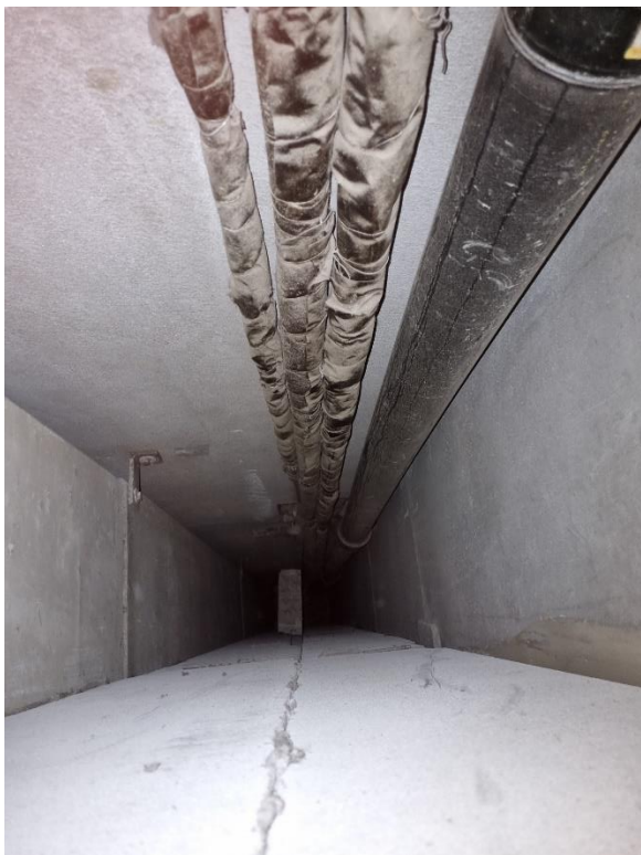
Dålig isolering samt klamring
