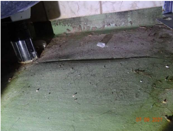
Bild 1: Otät golvmatta under badkar
