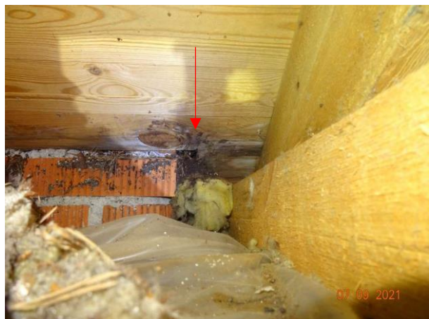
Bild 18: Tecken på fuktintrång i anslutning till skorsten
