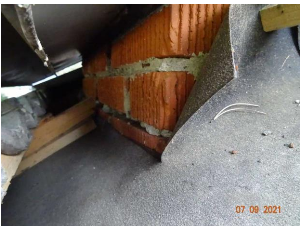
Bild 5: Underbeslag saknas kring skorsten, papp ej uppviktt i nedre kant, uppviktt med nedviktböj som leder in vatten i sidorna
