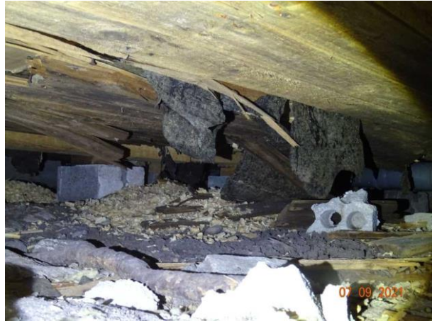
Bild 8: Blindbotten har rasat, rötskadat material, kutterspån och isolering på marken
