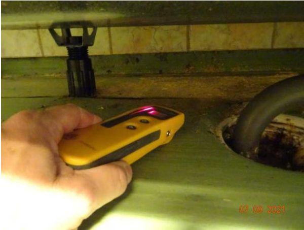
Bild 7: Förhöjda fuktindikationer i badrum
