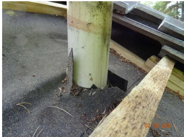
Bild 4: Underbeslag saknas kring rör genomföringar
