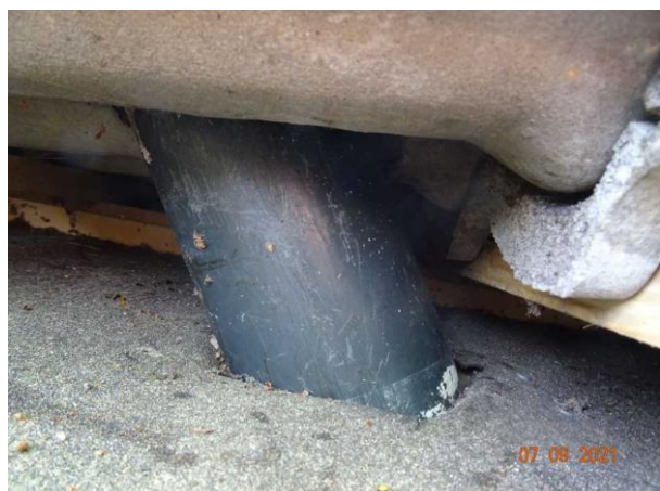
Bild 6: Tak ej fackmässigt lagt, otäta anslutningar
