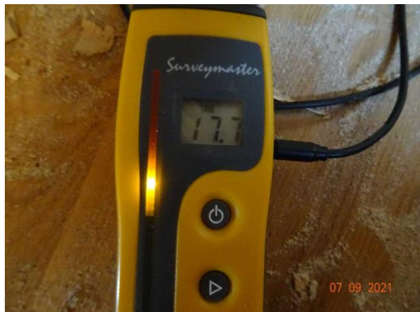
Bild 10: Fuktvot i bjälklag i sovråm bredvid badrummet är över gränsvärdet
