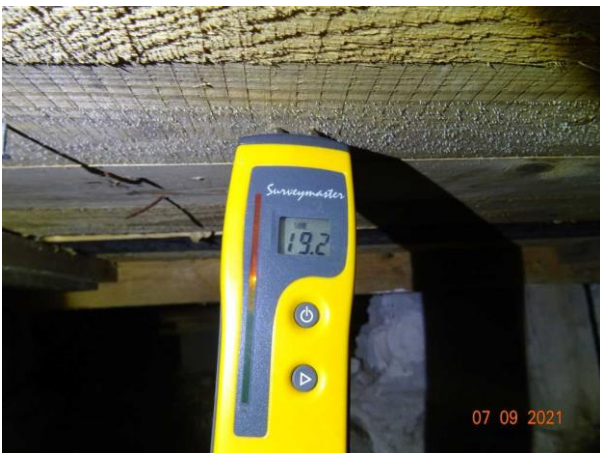
Bild 9: Fuktvot i trossbotten är över gränsvärdet, mikrobiell påväxt är synlig
