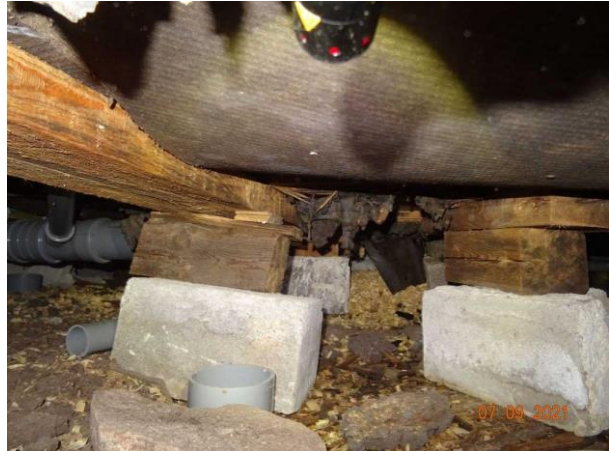
Bild 14: Skador i grunden bedöms finnas i närheten av hörnet bakom badrummet, höger om kontrollpunkt 3
