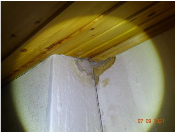
Bild 3: Fuktläck i skorsten, närmast tak
