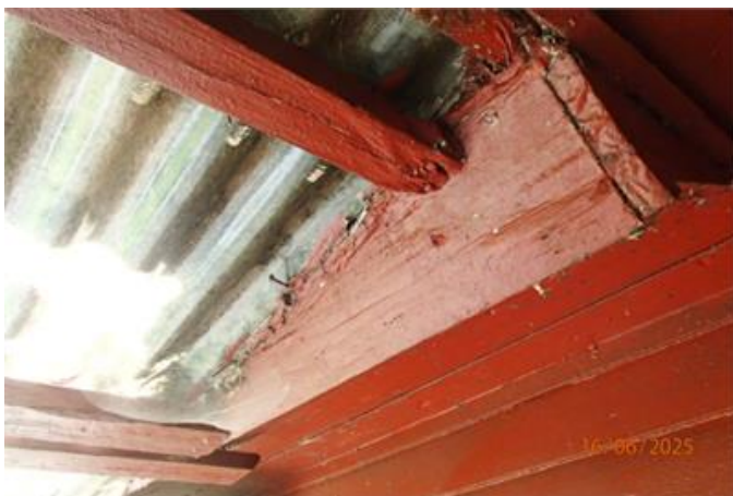
Läckage förekommer / rötskador vid entré tak/ altantak
