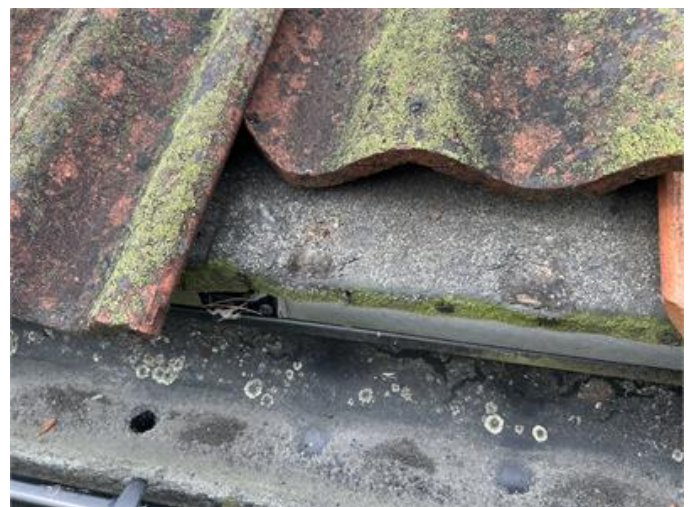
Tak: Pappen är torr samt sprickor förekommer.
