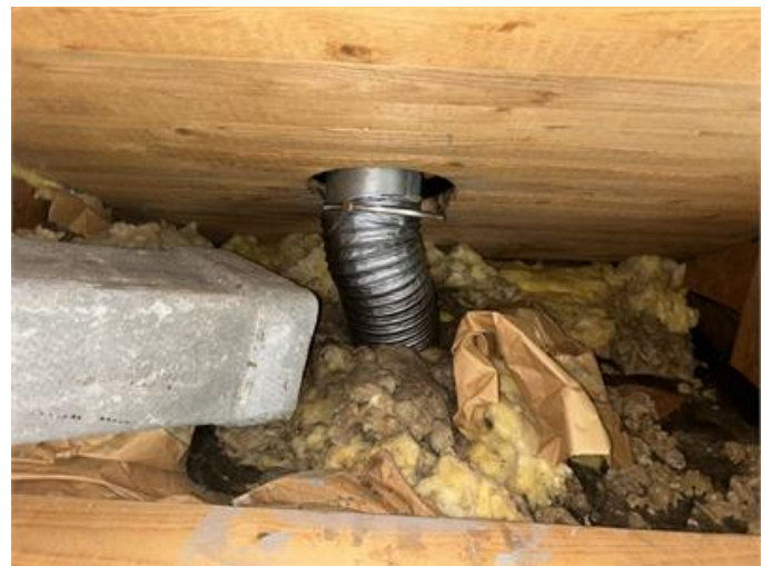
Nockvind: Oisolerad Imkanal samt felaktigt rör. Eternitrör noteras.
