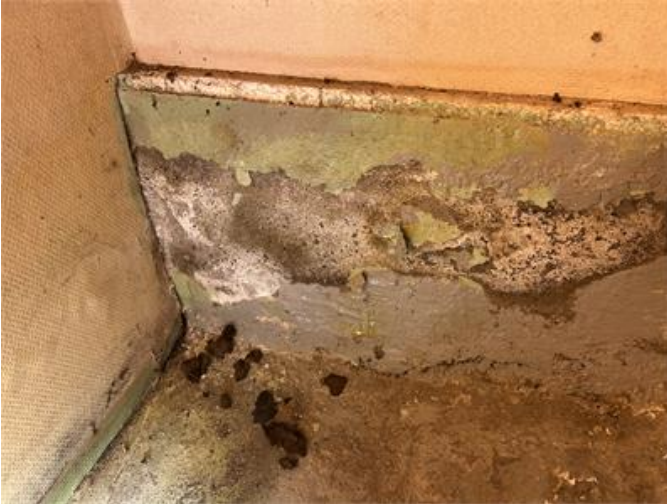
Källare: Färgsläpp samt kalk/saltutfällning noteras.
