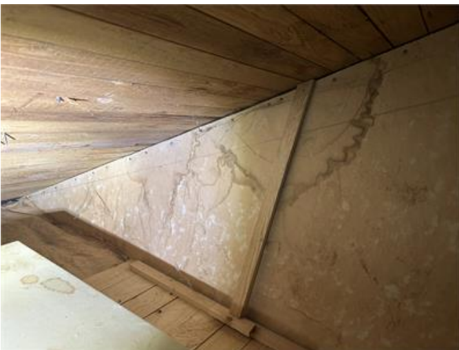
Nockvind: Fuktanvisning på tapeter.
