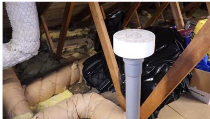
Avloppets luftarrör leds inte ut genom yttertaket utan avslutas på vinden med en vakuumentil.
