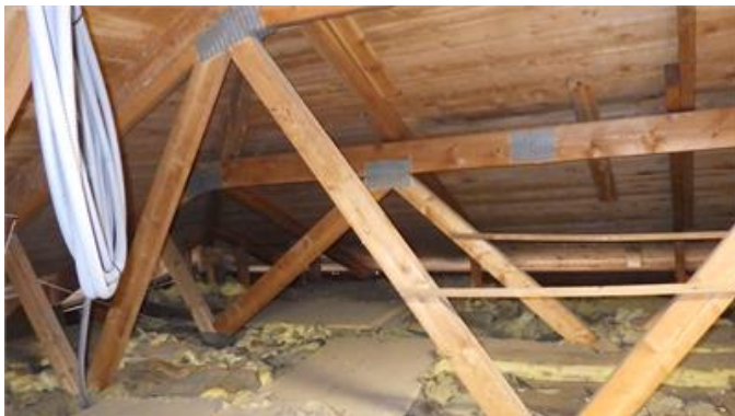
Mikrobiell påväxt på insida yttertaket på vinden
