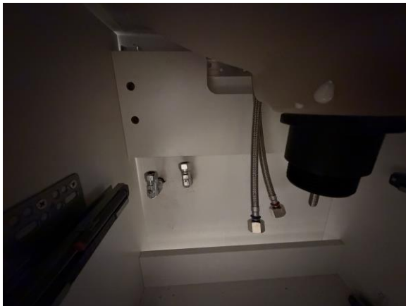
Vatten/avlopp till kommod i wc ej inkopplat.
