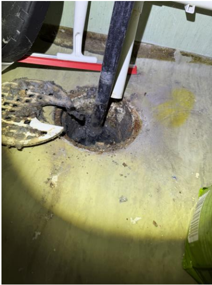
Gjutjärnsbrunn i tvättstuga.
