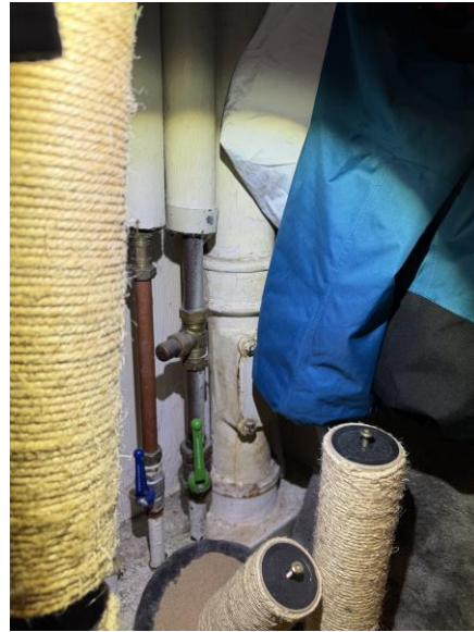
Gjutjärnsstam i tvättstuga.
