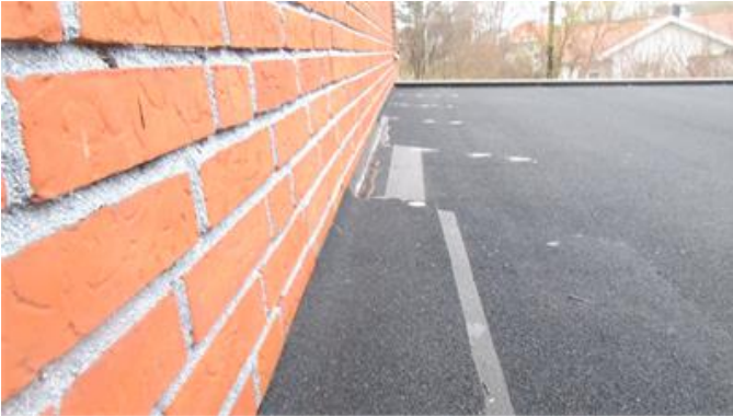
Ingen plåt mellan husliv och garagetak.
