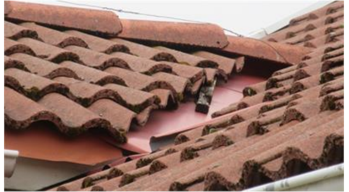
Rötskada i läkt på tak.
