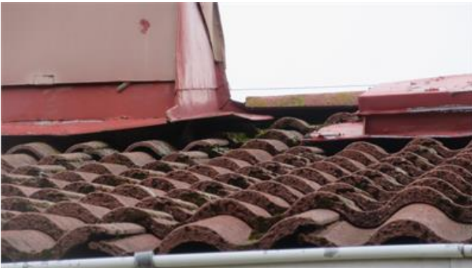
Bristfälliga plåtar på tak.
