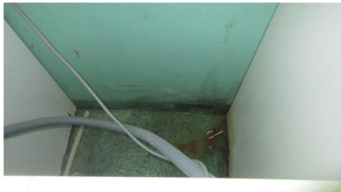
Skada nederkant vägg i tvättstuga.
