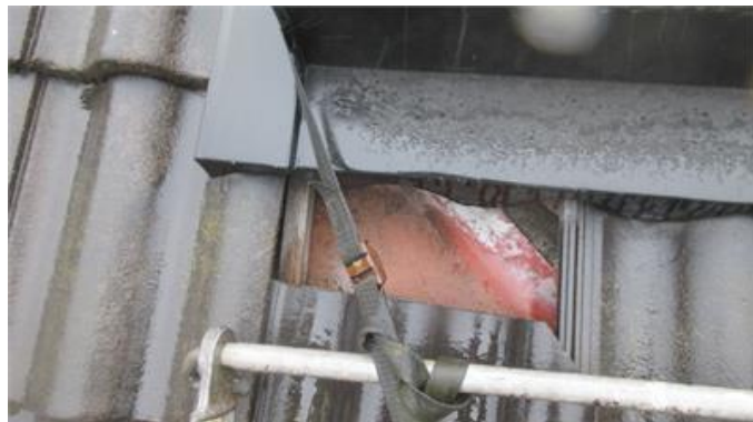
Betongpanna ligger fel.
