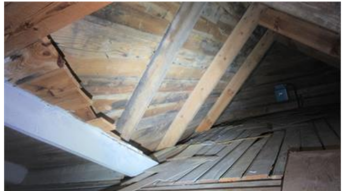
Mikrobiell påväxt på nockvindens underlagstak.
