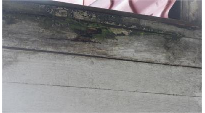
Rötskada under balkong.
