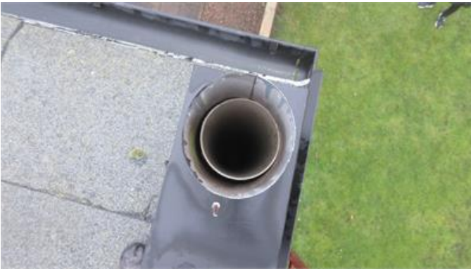
Otät ventilationsgenomföring på tak.
