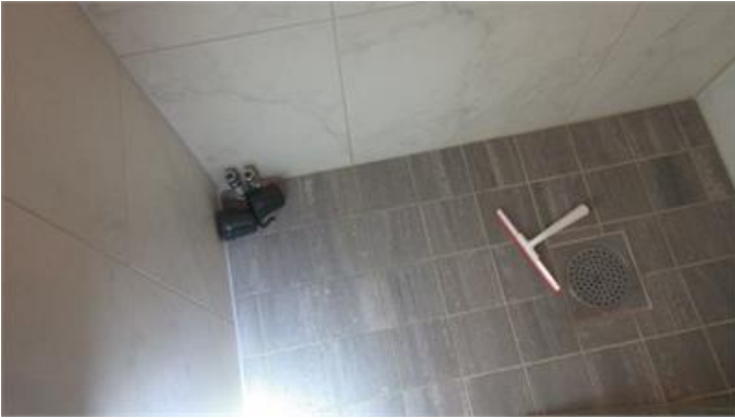
Rör genomföringar i golv i våtzon 1.
