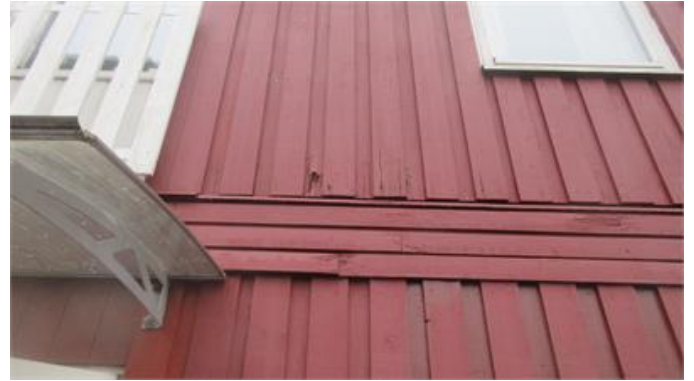
Rötskador i fasadpanel.
