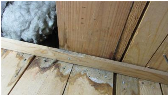
Missfärgning på golv i sidovind.
