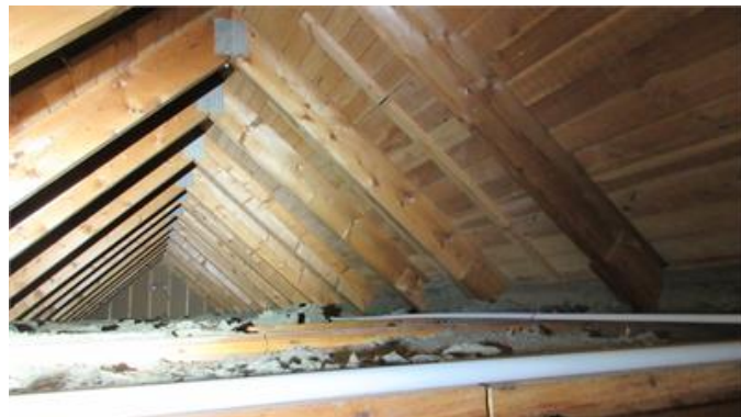
Mikrobiell påväxt pånockvindens underlagstak.
