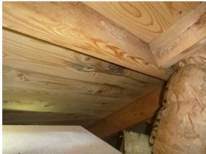
Bilden visar missfärgning i underlagstaket.
