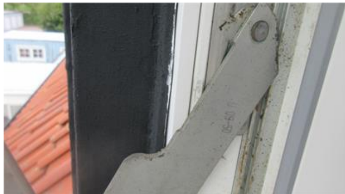
Otättheter mellan plåt och fönster i takkupa.
