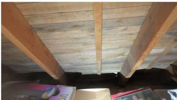
Mikrobiell påväxt pånockvindens underlagstak.
