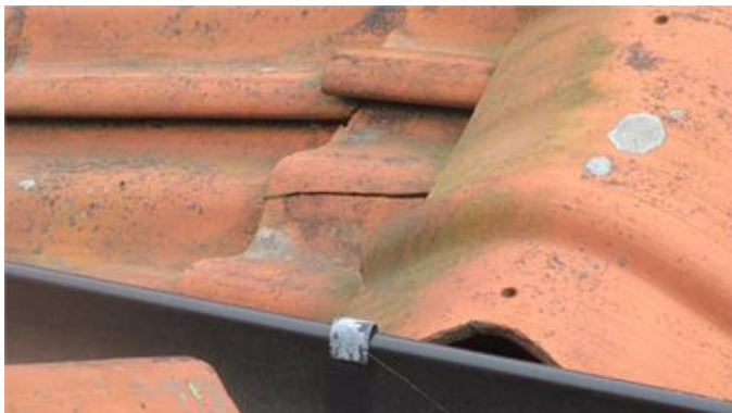
Sprucken takpanna på entrétak.
