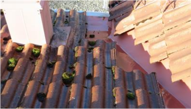
Pannor ligger fel/fattas i anslutning till vinkelränna.
