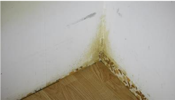
Påväxt/missfärgning på vägg i sovrum 2.
