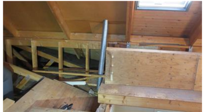
Oisolerat ventilationsrör pånockvind.
