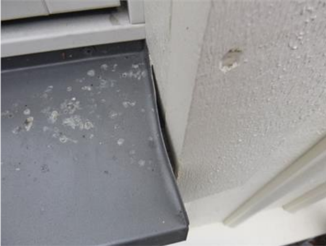
Bilden visar exempel på otätheter/brister vid/med plåtdetalj.
