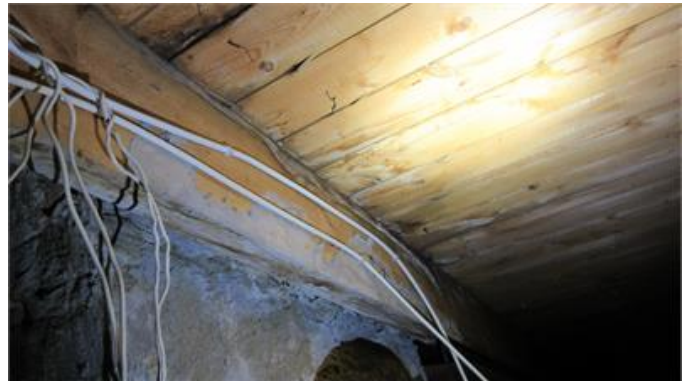
Missfärgningar intill murstock pånockvind.
