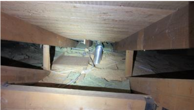
Oisolerat ventilationsrör pånockvind.
