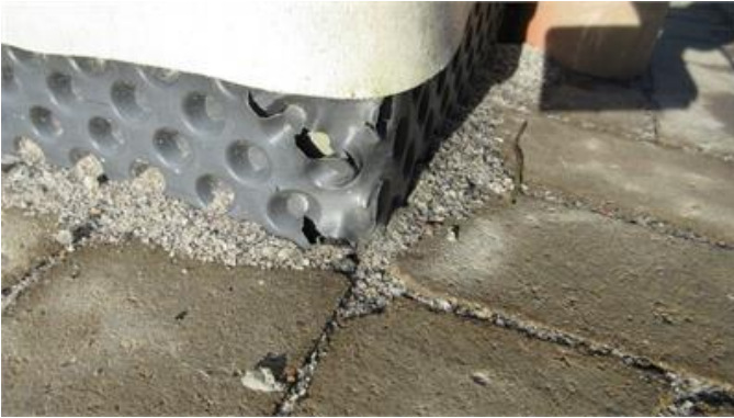
Skadad "Platonmatta" ovan marknivå.
