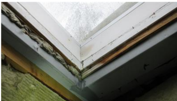
Missfärgningar runt takfönster samt pågående arbete.
