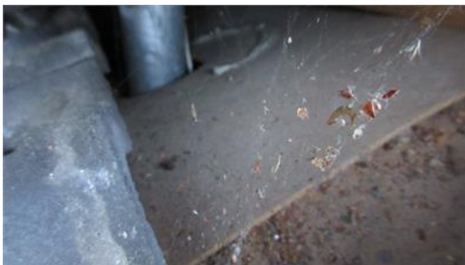
Inget underbeslag genomföring tak.
