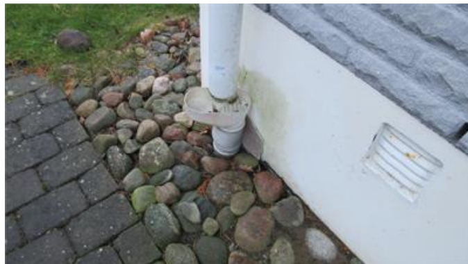
Bristfälligt anslutet stuprör.
