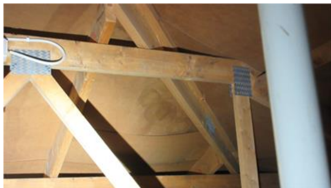
Missfärgning pånockvindens underlagstak.
