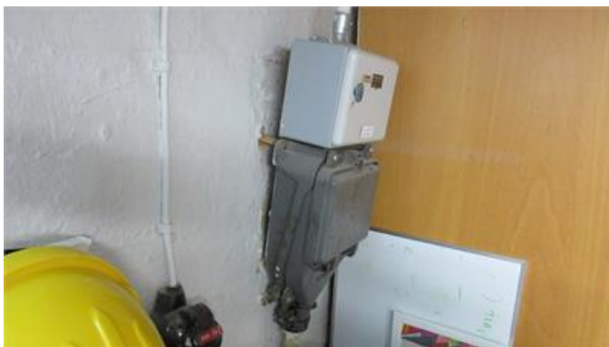
Lös elinstallation källare.
