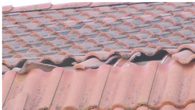
Betongpavon blåst av tak.
