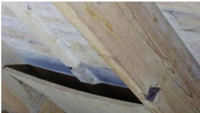
Mikrobiell påväxt pånockvindens underlagstak.
