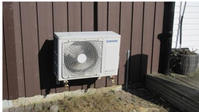
Värmepump intill hus.
