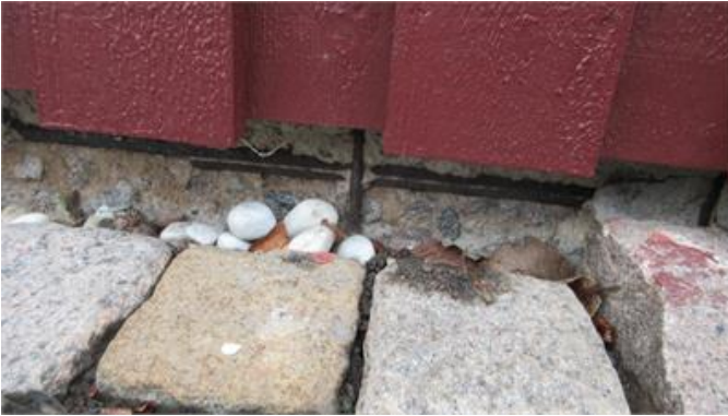
Frostsprängningar i sockel.
