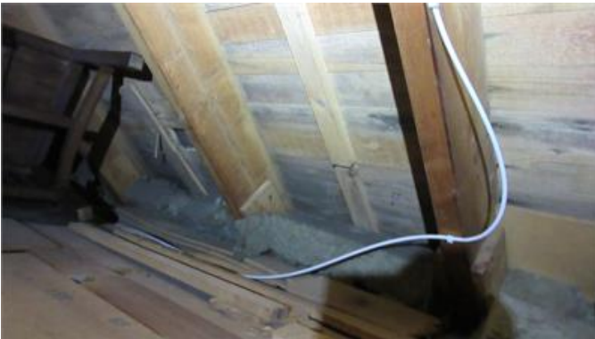
Mikrobiell påväxt på nockvindens underlagstak.
