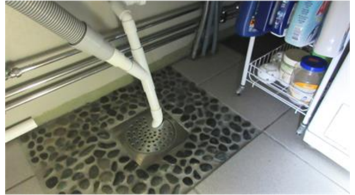
Golvbrunn nära vägg samt rörgenomföringar i golv i tvättstuga.
