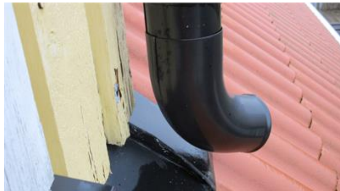
Rötskada i panel.
