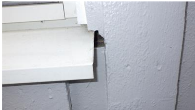
Otät infästning av fönsterbleck
