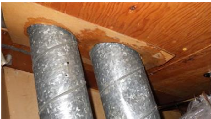
Fukthälgar på underlagstaket på en sidovind
